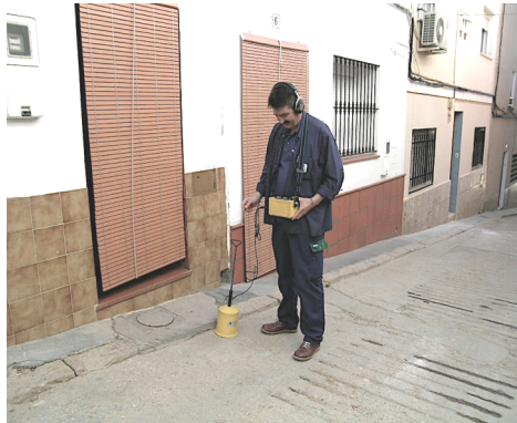
Fig. 1.105.- Localización de la fuga mediante ultrasonidos.
