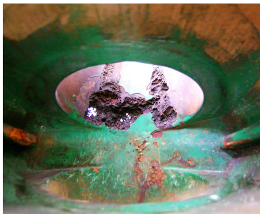
Fig. 2.9.- Vista superior del cuerpo de la válvula. Patología en la dirección y sentido del fluido.
