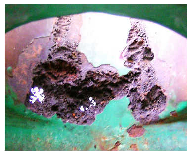
Fig. 2.10.- Detalle de la patología por erosión – cavitación. Se puede observar la perforación del cuerpo de la válvula.
