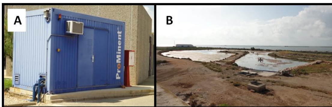
Figura 16. Ozonizador por donde pasa el agua antes y después de pasar por la sala de patologías (A). Balsa de sedimentación (B).
