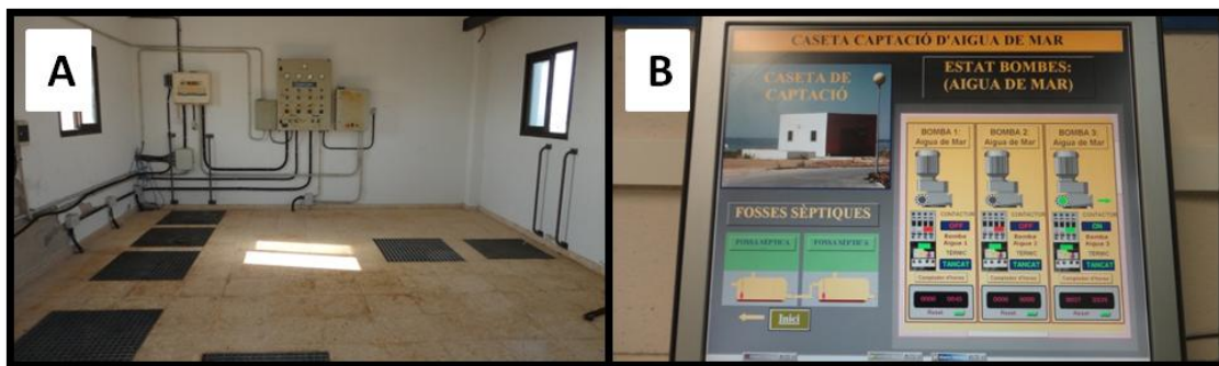
Figura 13. Caseta de captación de aguas (A) donde las bombas están sumergidas). Desde el ordenador de la sala de lupas se puede controlar el estado de las bombas (B).
