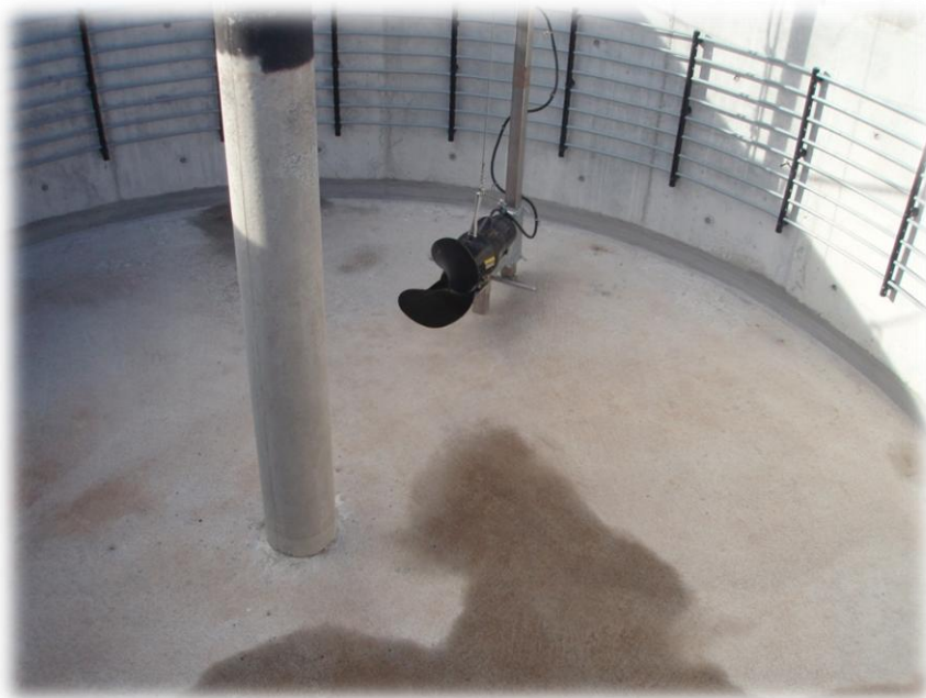
Figura 10. Reactor de mezcla completa sin recirculación de Finca Mouriscade.
