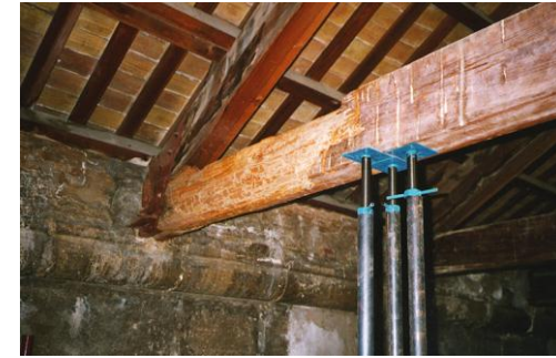
Fotografía del aspecto que presentaba la cubierta de la planta segunda del Consulado, en el año de 1998, antes de que fuere tratada contra el ataque de termitas.
