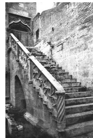
Fotografía del intradós del muro de cerca Norte y escalinata de acceso a la planta primera del Consulado, con el detalle de su lamentable estado de conservación en el año de 1930
