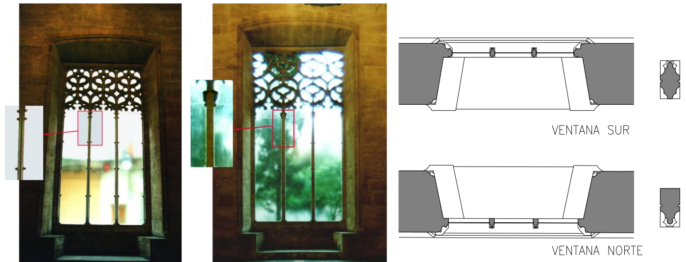
Fotografías que muestran la situación de los parteluces en la actualidad después de ser restaurados. Aunque desconozco el autor, como puede observarse la intervención fue bastante desafortunada, puesto que el moldurado del intradós de la preexistencia fue sustituido por una pieza lisa. Junto a la fotografía acompaño un plano de sección en planta, que muestra la estereotomía que tenían los referidos parteluces (ventanales Sur) y, junto a ella, otra que muestra el estado actual (ventanales Norte).
