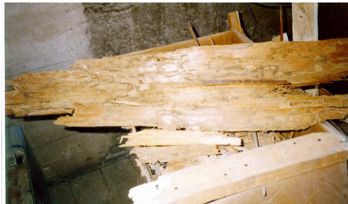
Fotografía que pude tomar en el año 1998 que muestra restos de madera deteriorada, extraída de los tirantes de las cerchas de la cubierta del Consulado fuertemente atacados por las termitas.
