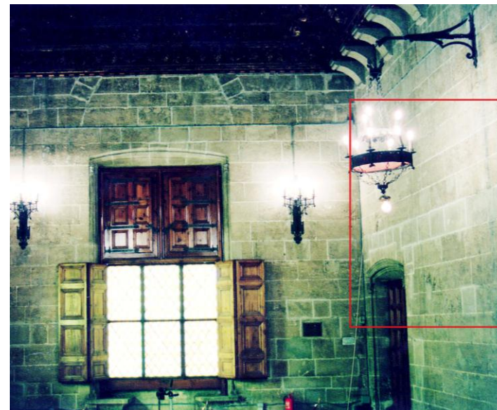
Detalle del intradós de los muros del Salón del Consulado de Mar. La diferente pátina de algunos sillares, así como retoques en algunas llagas y tendeles delatan las posibles piezas que fueron sustituidas por Carlos Soler.
