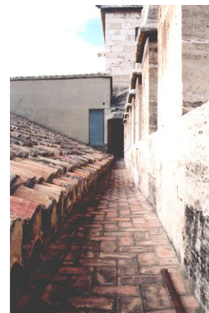
Fotografías de la colección privada de D. Emilio Rieta, que recogen el estado que presentaba la cubierta del Salón Columnario, sobre todo, por su ala Noroeste. Acompaño, también, una fotografía de la zona circundante a la cubierta que fue restaurada por el mismo arquitecto.
