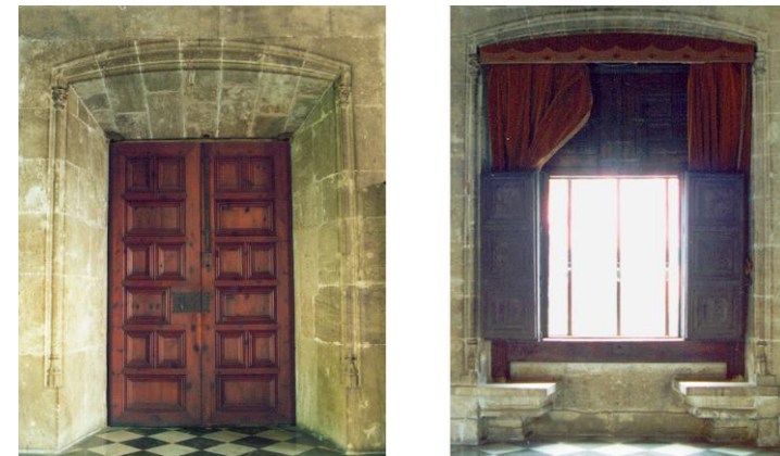
Fotografía que muestra el intradós de los huecos de la planta baja del Consulado y el que practicó Miquel Joan Porcar el año 1546.
