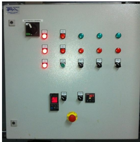
Figura 46. Cuadro eléctrico principal
