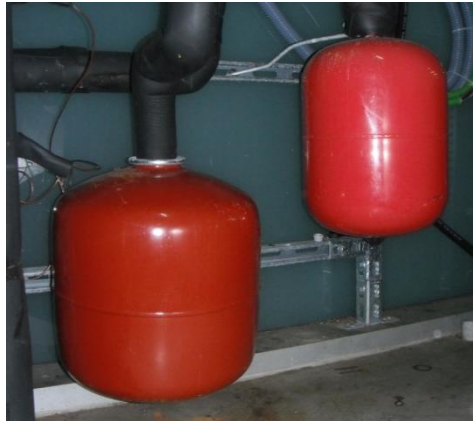
Figura 29. Vasos de expansión del circuito primario y secundario
