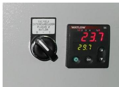
Figura 3. PID WATLOW e interruptor del actuador del foco frío
