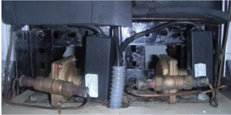
Figura 48. Flujostatos de presión diferencial del evaporador y condensador
