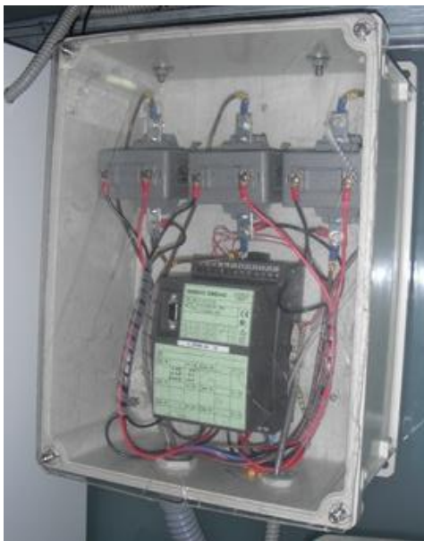
Figura 47. Analizador de redes del chiller Camille Bauer Sineax DME442
