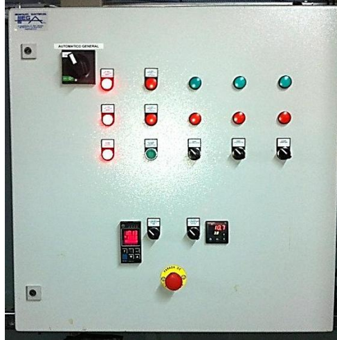
Figura 4. Cuadro eléctrico principal con las 3 alarmas activadas
