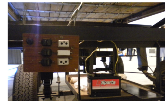
Fig. 108. Sistema eléctrico obsoleto
