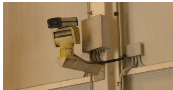
Fig. 32. Cámara de seguridad en la nave de pasos
