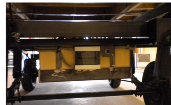
Fig. 107. Sistema eléctrico protegido
