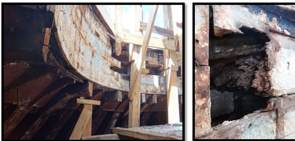
Figura 36.2. Falta de conexión entre el tambor superior y las nervaduras. Fuente: Propia, M. Villanueva
