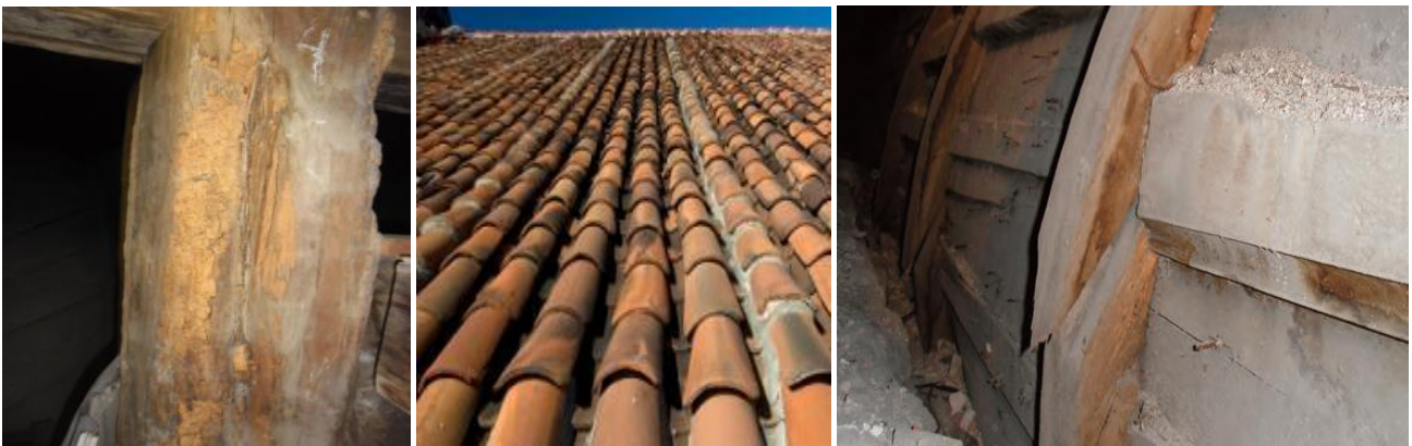
Figura 27.2. Horcón con pérdida de sección por los agentes xilófagos, rotura y desplazamiento de tejas y fisuramiento de la estructura portante del falso techo (de izq a dcha). Fuente:OCC
