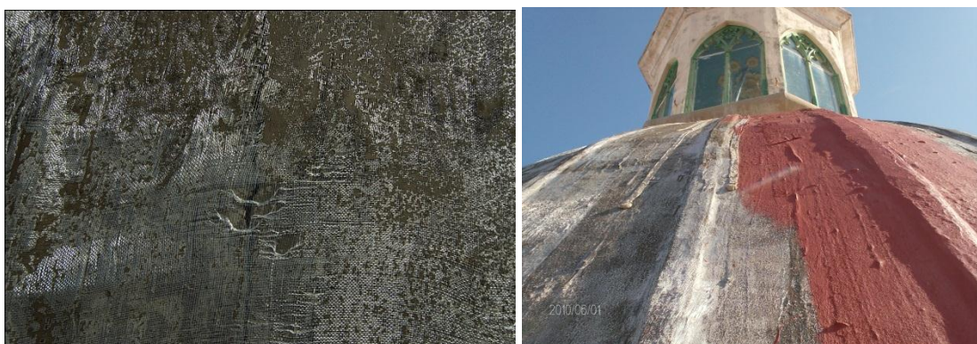
Fig 38.2. Daños superficiales en el exterior de la cúpula. Fuente: OCC
