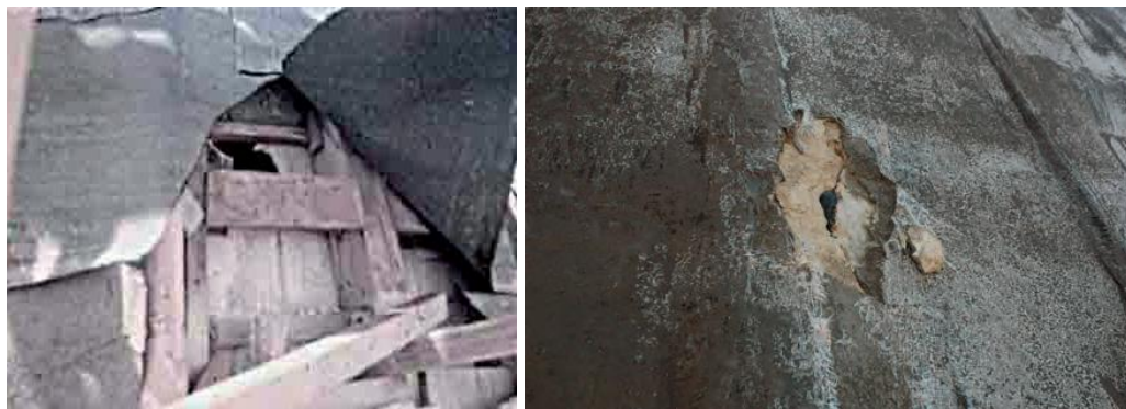
Figura 35.2. Fallos en el recubrimiento exterior. Fuente: OCC
