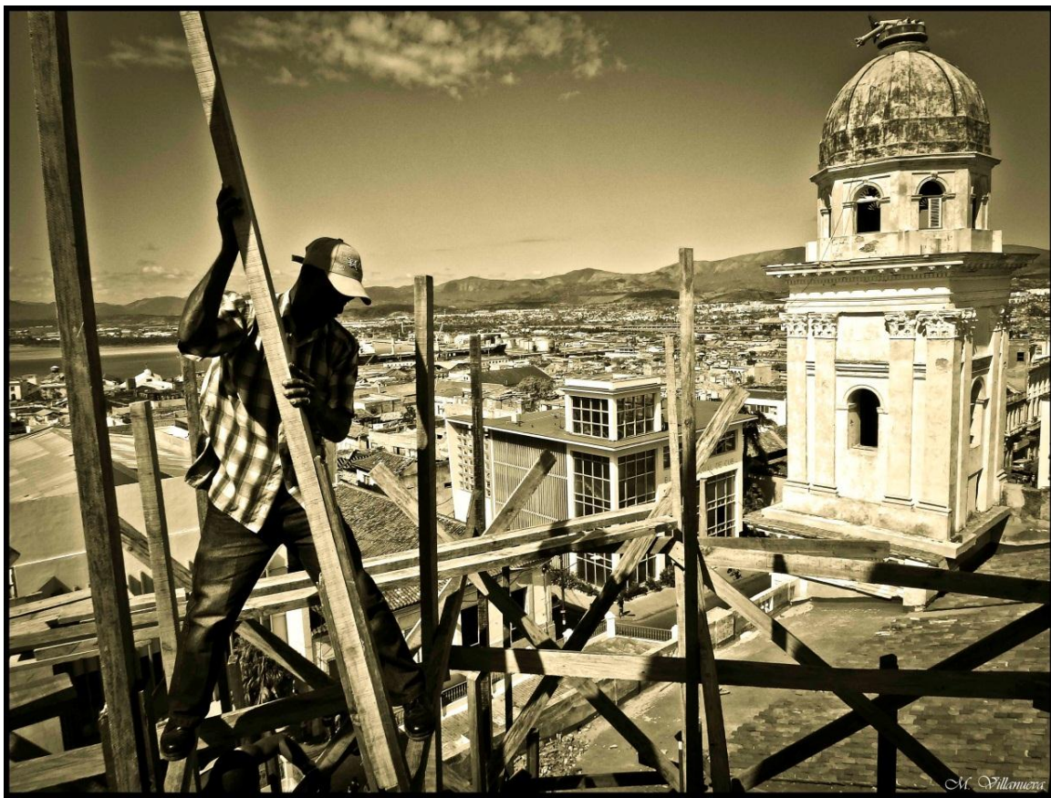
Fig.39.2. Trabajos de reconstrucción del andamiaje de la Cúpula. Fuente: Propia, M. Villanueva.
