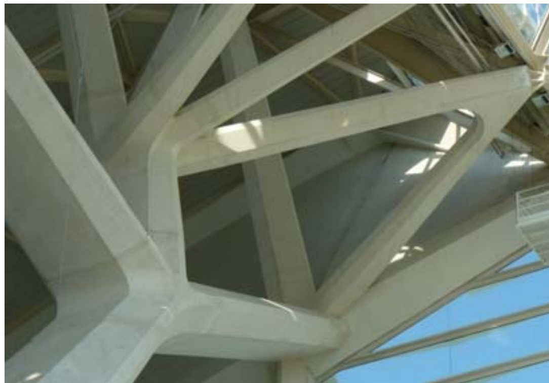
Fotografía de las piezas 3 y 4 (extrema) terminadas.
