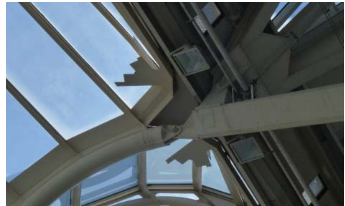
Articulación de la pieza 6 con la fachada norte y con la cubierta.
