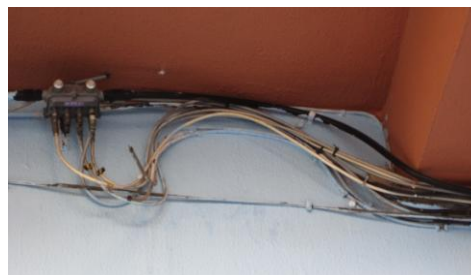
Fig. 26. Instalaciones eléctricas que provocan daños al muro.
