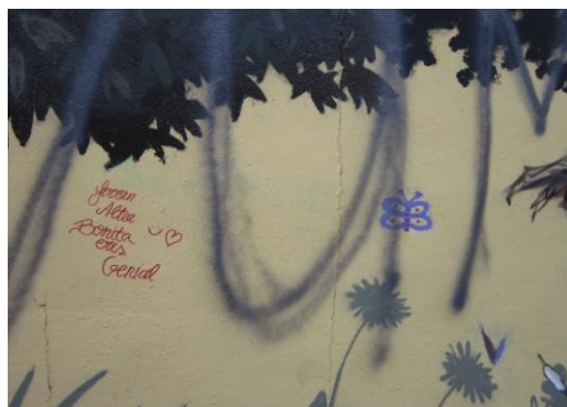
Fig. 22. Manchas provocadas por restos de pegatinas.
