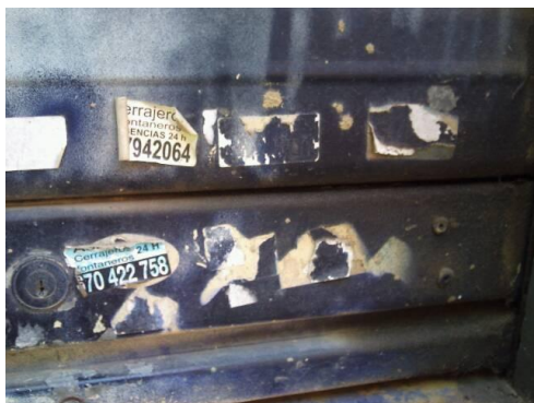
Fig. 23. Pintadas con spray sobre el muro.
