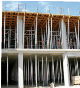
Fig. 2.23. Proceso de cimbrado-clareado-descimbrado, en un edificio con una planta cimbrada y otra clareada.
