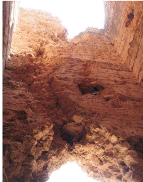
29. Derrumbe parcial de toda una franja vertical de tapia interior desde la brecha de acceso hasta la coronación (fotografía: Mileto & Vegas)
