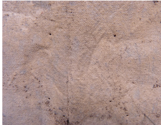
Imagen 42. Estado del soporte de la zona tratada con Biotín R® al 3% en etanol. Se aprecia la zona oscurecida
