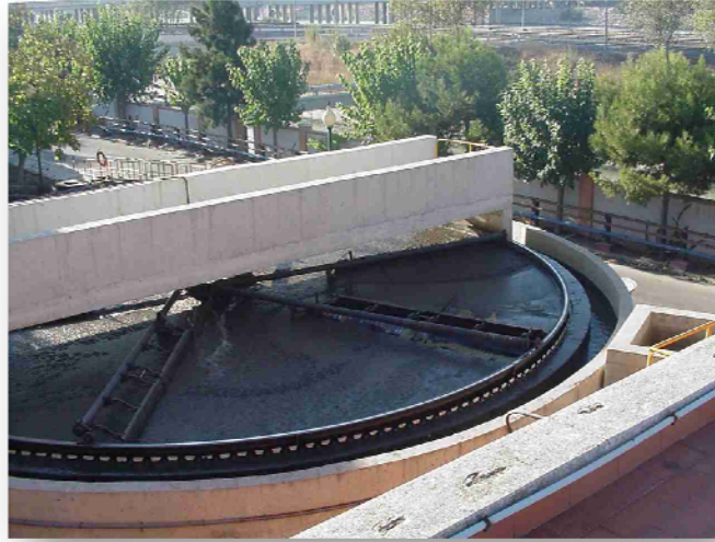
Figura 2. Flotador de la EDAR de Pinedo (Valencia)
