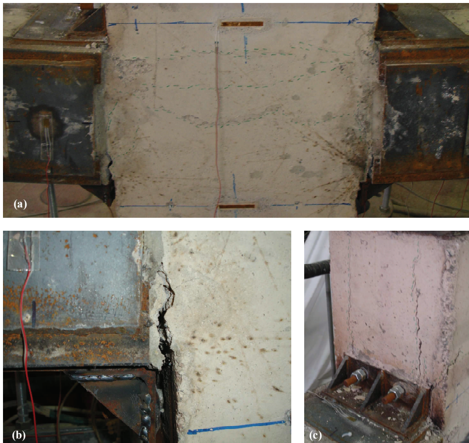
Fig. 3.25. Rotura de las probetas B-400; (a) Vista general; (b) Zona traccionada, fisuración el entronque del soporte con el nudo viga-soporte y “despegue” del capitel; (c) Zona en compresión, capitel aplastando el hormigón del nudo.
