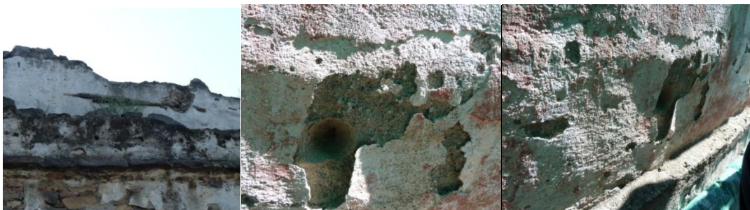
Figura 3.5.18. Microrganismos y desconchamientos a causa de sales que afectan el mortero.
