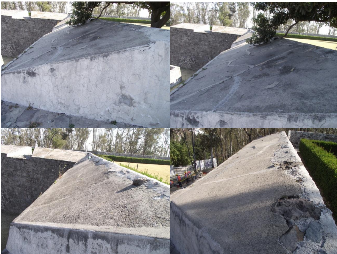
Figura 3.4.59. Estado actual de la zona superior de los muros.
