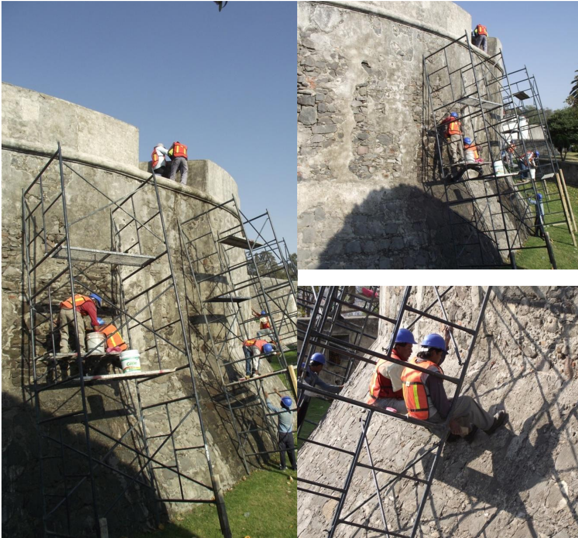
Figura 3.1.14.- 3.1.15-3.1.16. (de arriba abajo y de derecha a izquierda) operarios trabajando en el andamio con pendiente instalado en los bastiones.
