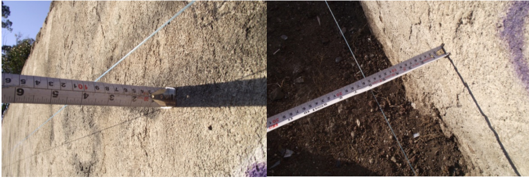
Figura 3.2.14. - Figura 3.2.15. Muestra de pandeo al mostrar el nivel en los muros.
