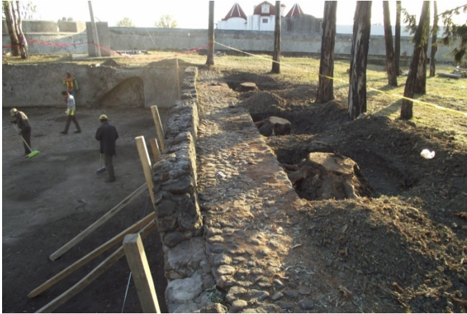
Figura 3.2.32. Tocones en la zona perimetral del aljibe.
