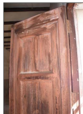
Abombamientos de carpintería en balcón de primera planta
