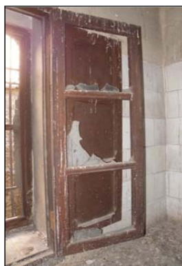
Desperfectos en vidrios en cocina de primera planta.
