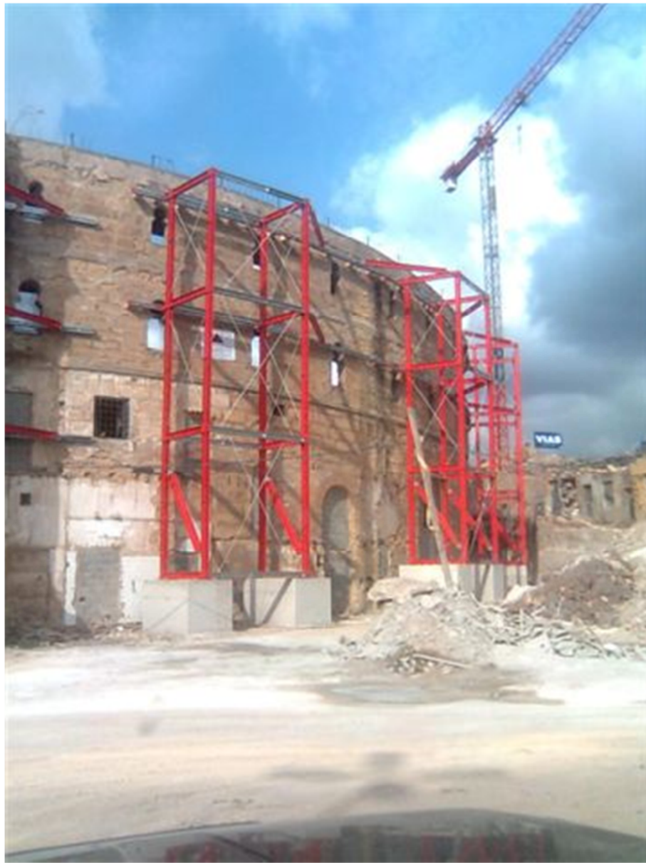
Sistema estabilizador en muro curvo. Plaza de Toros de Cartagena.
