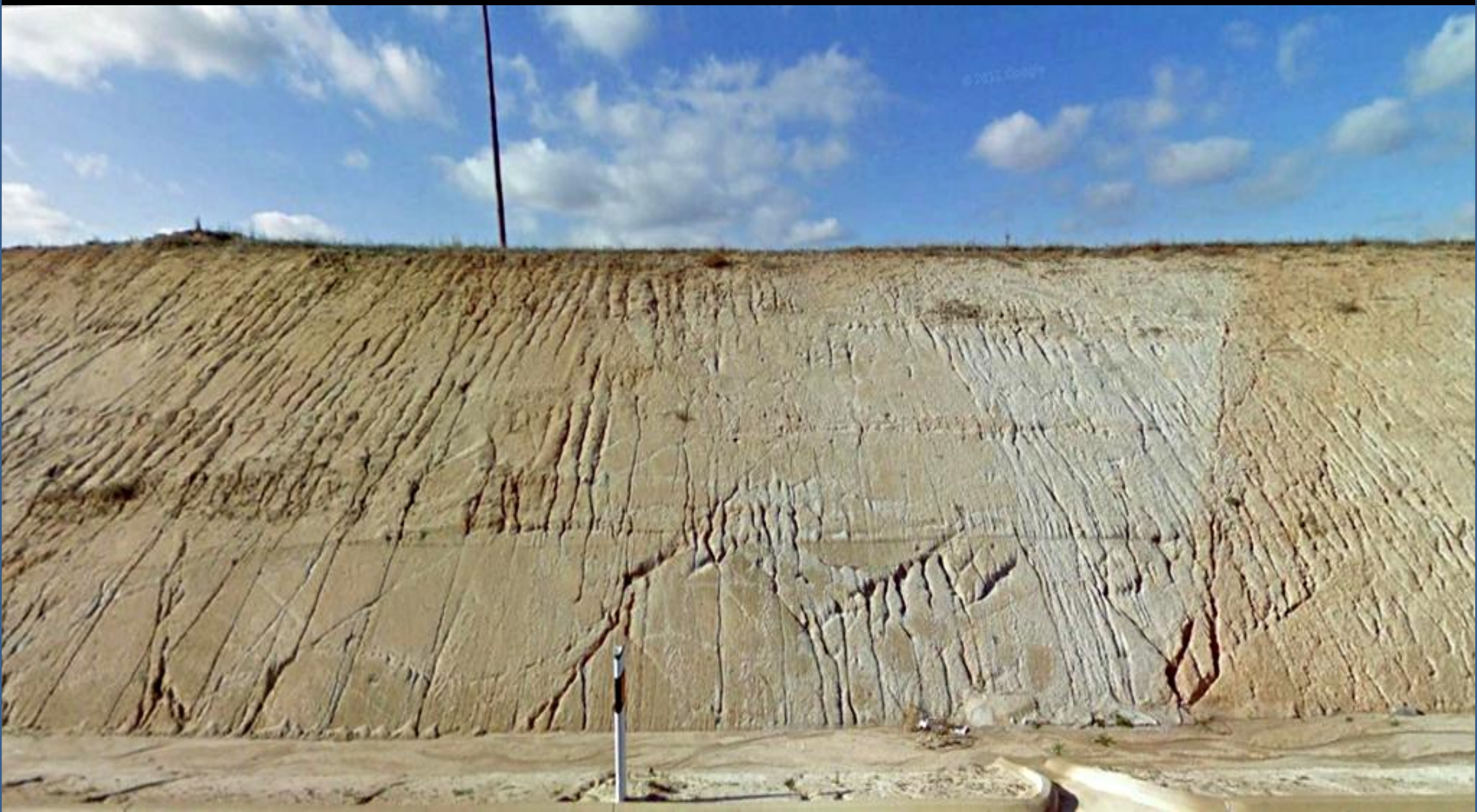
Talud en granodioritas alteradas. N de Casa Grande. N centro Hoja de Monterrubio de La Serena, Badajoz.
