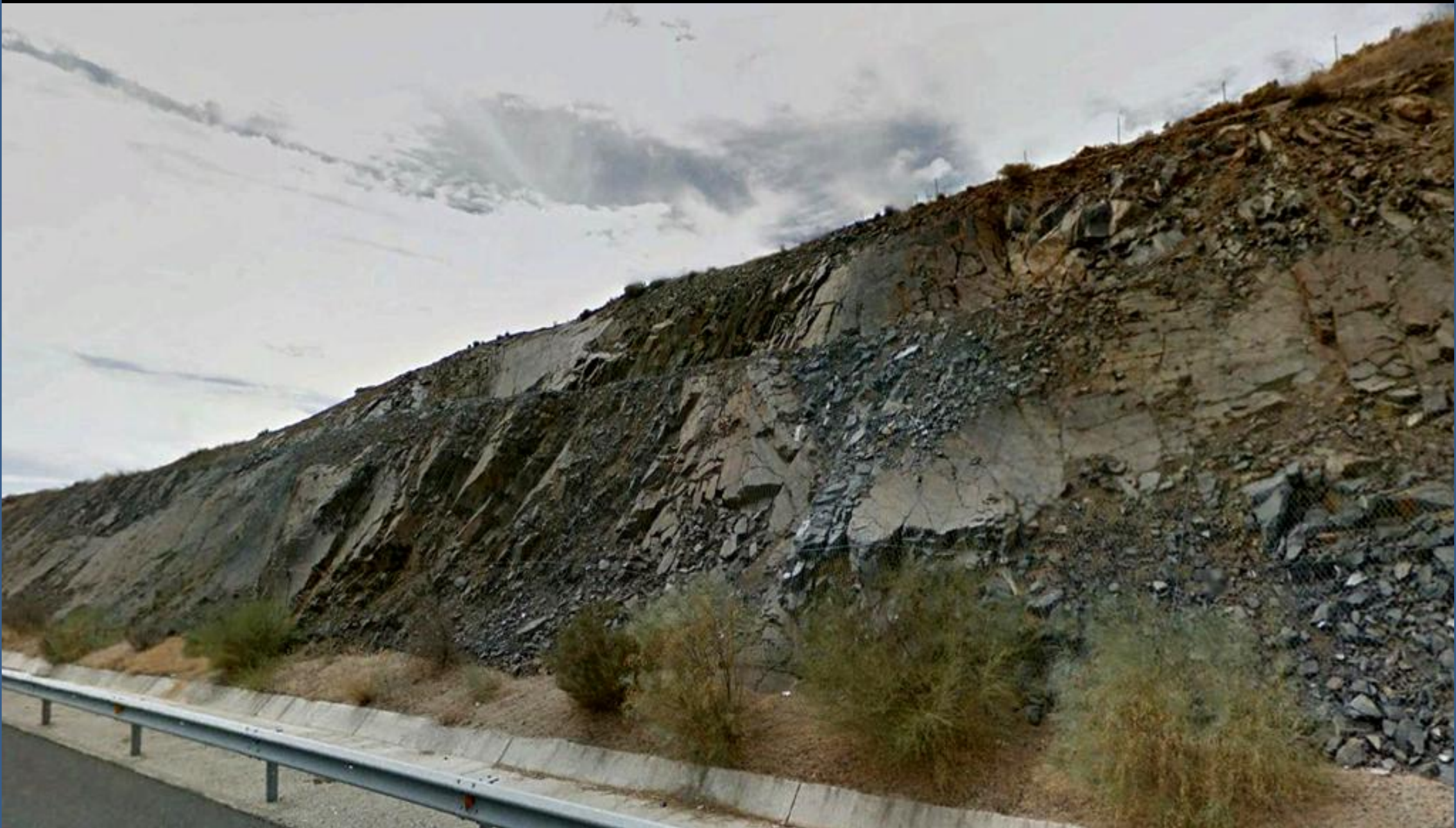
Inestabilidad de talud con mallazo sobre esquistos, con planos de esquistosidad y espejos de falla, del Precámbrico. Al E de Monesterio. Badajoz. Centro E Hoja.
