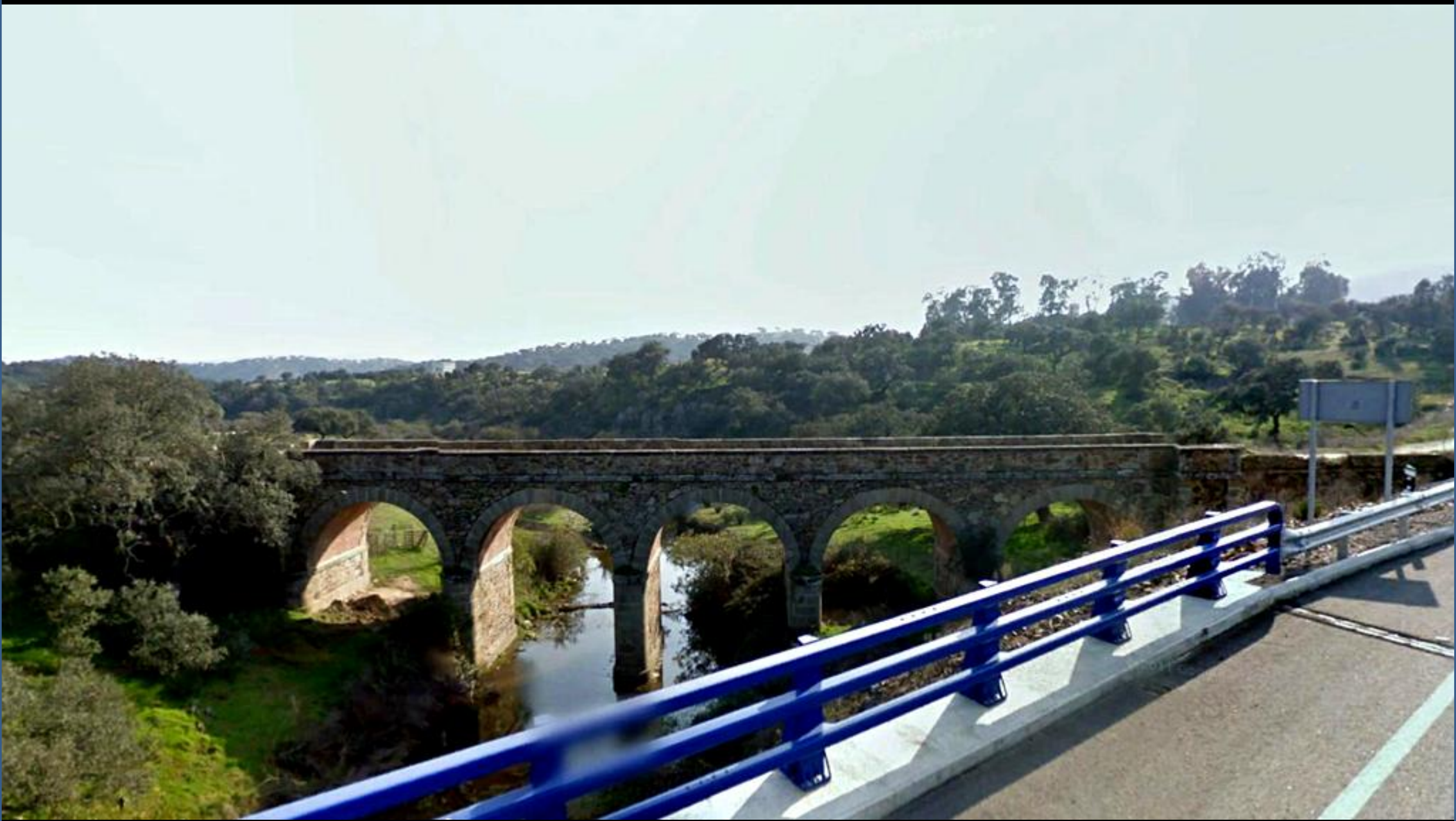
Puente en el Arroyo de Los Molinos, NW Hoja de Puebla del Mestre, Badajoz.
