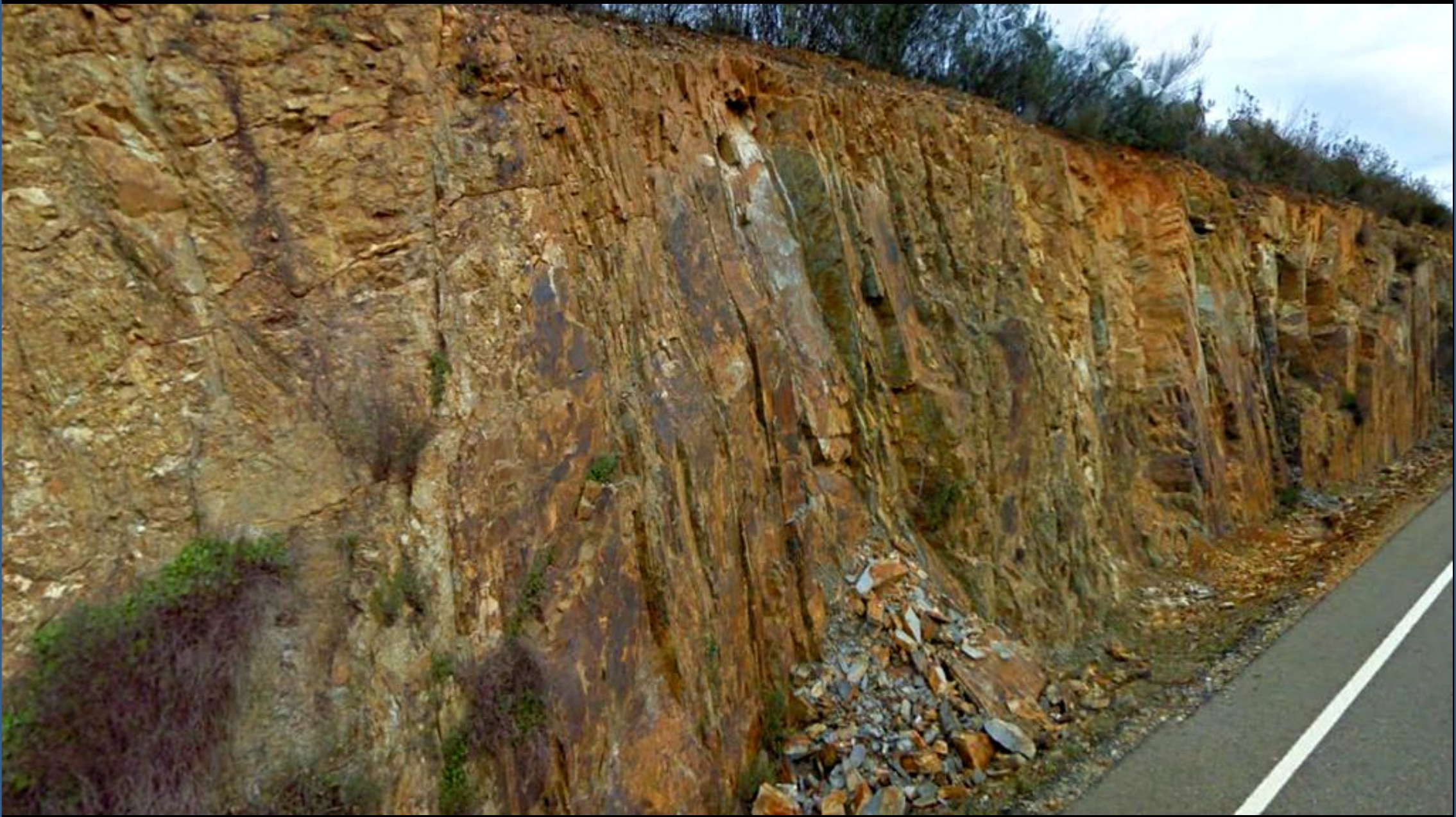
Pequeños desprendimientos entre planos de esquistosidad de las grauvacas y pizarras del Precámbrico Sup., E del Alto del Pelayo, S de Valverde. NE Hoja de Teso Moreno. Cáceres.
