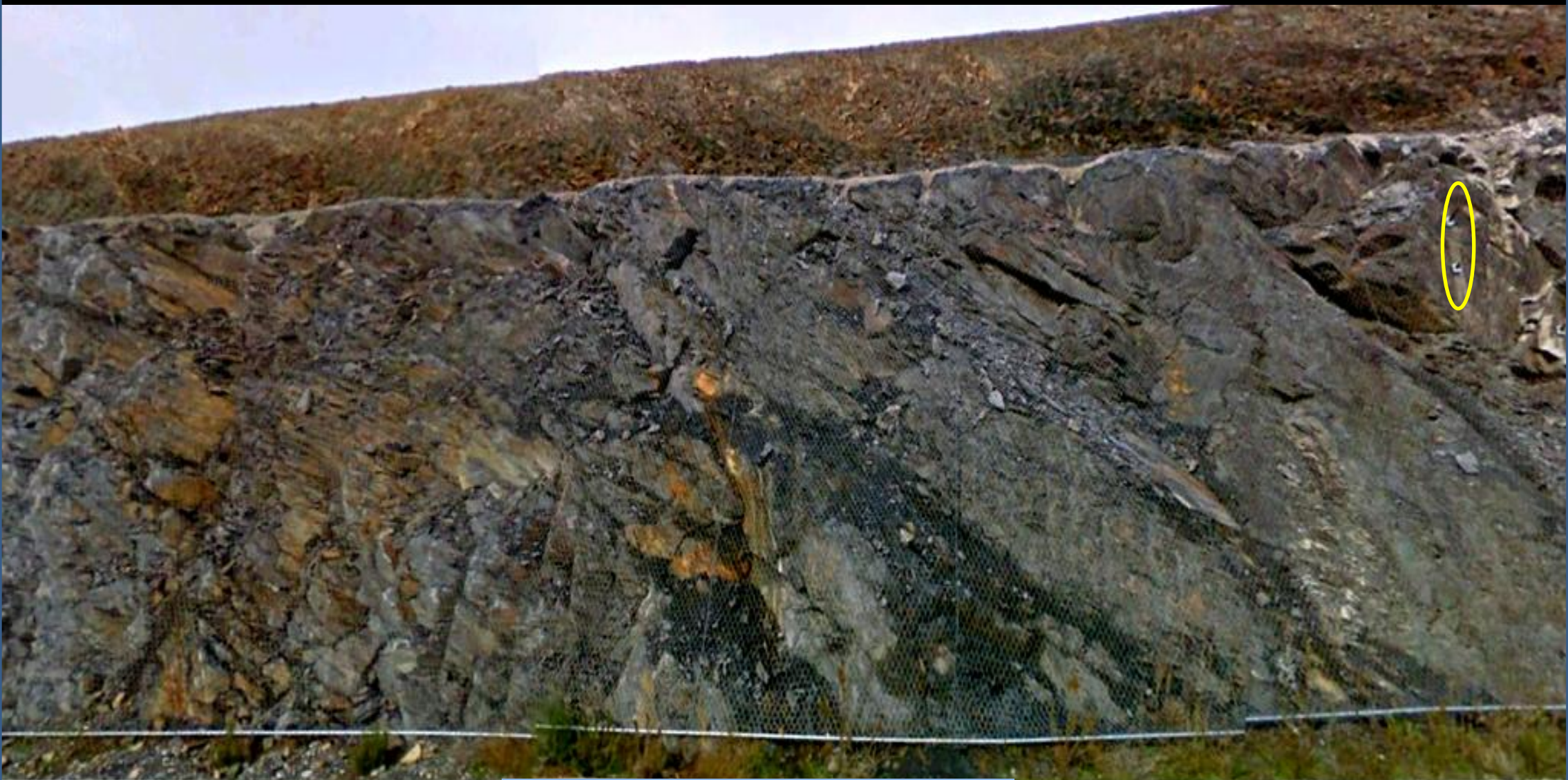
Mallazo y bulonado en las grauvacas del Precámbrico Sup. W de Malpartida de Plasencia, Cáceres. NW Hoja.
