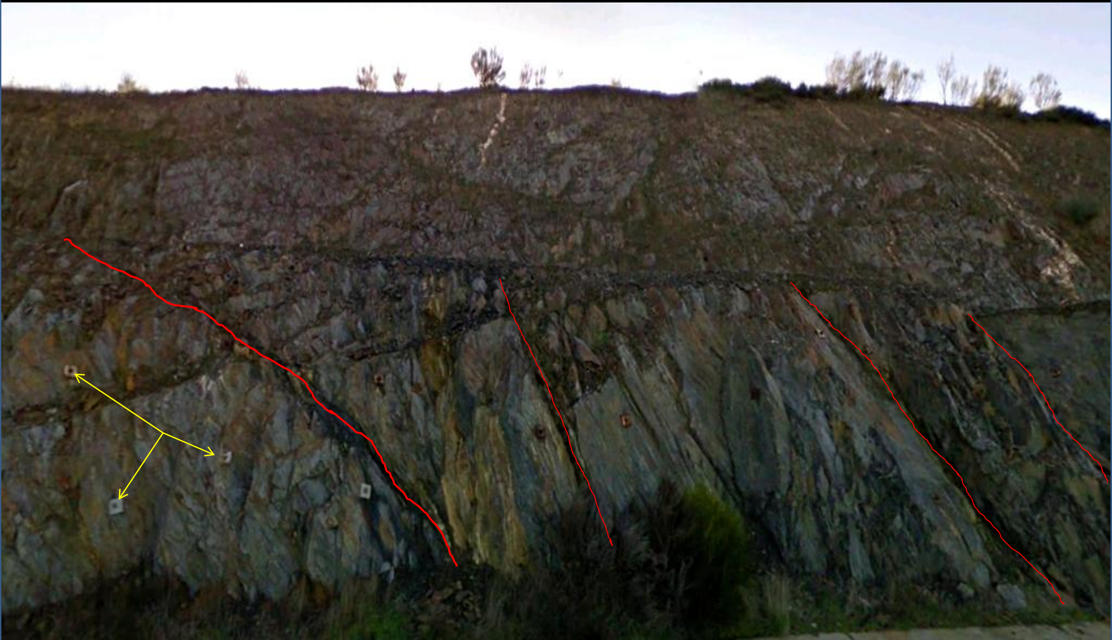
Junto sitio anterior: Fallas normales? pre-discordancia en las grauvacas y pizarras del Precámbrico Sup. Bulonado. SE del cerro Fuente del Sapo. SE de Riolobos. Centro E Hoja de Torrejoncillo.
