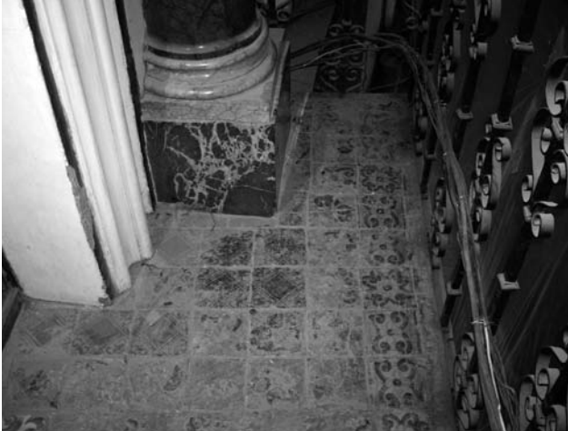
Figura 1. Estado inicial de la balconada nº 2 tras la primera limpieza
