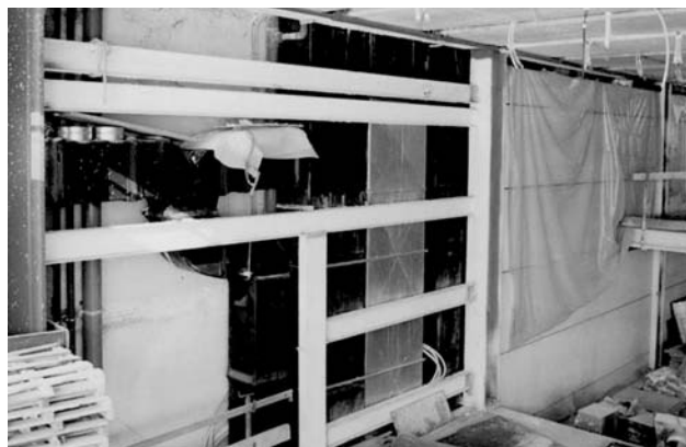
Figura 17. Medianera de instalaciones
