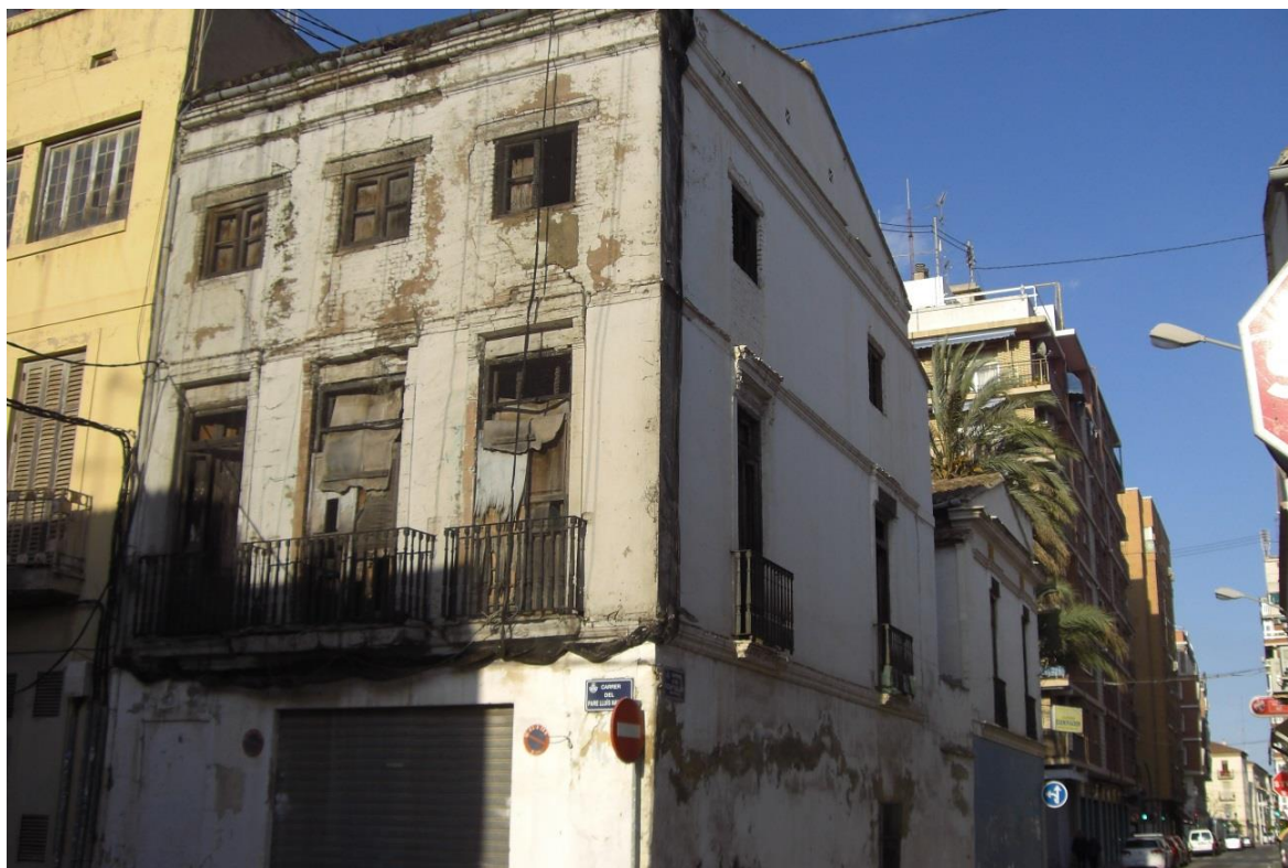
Imagen nº 45.- Vivienda para derribar en C/ Vicente Gallart.
