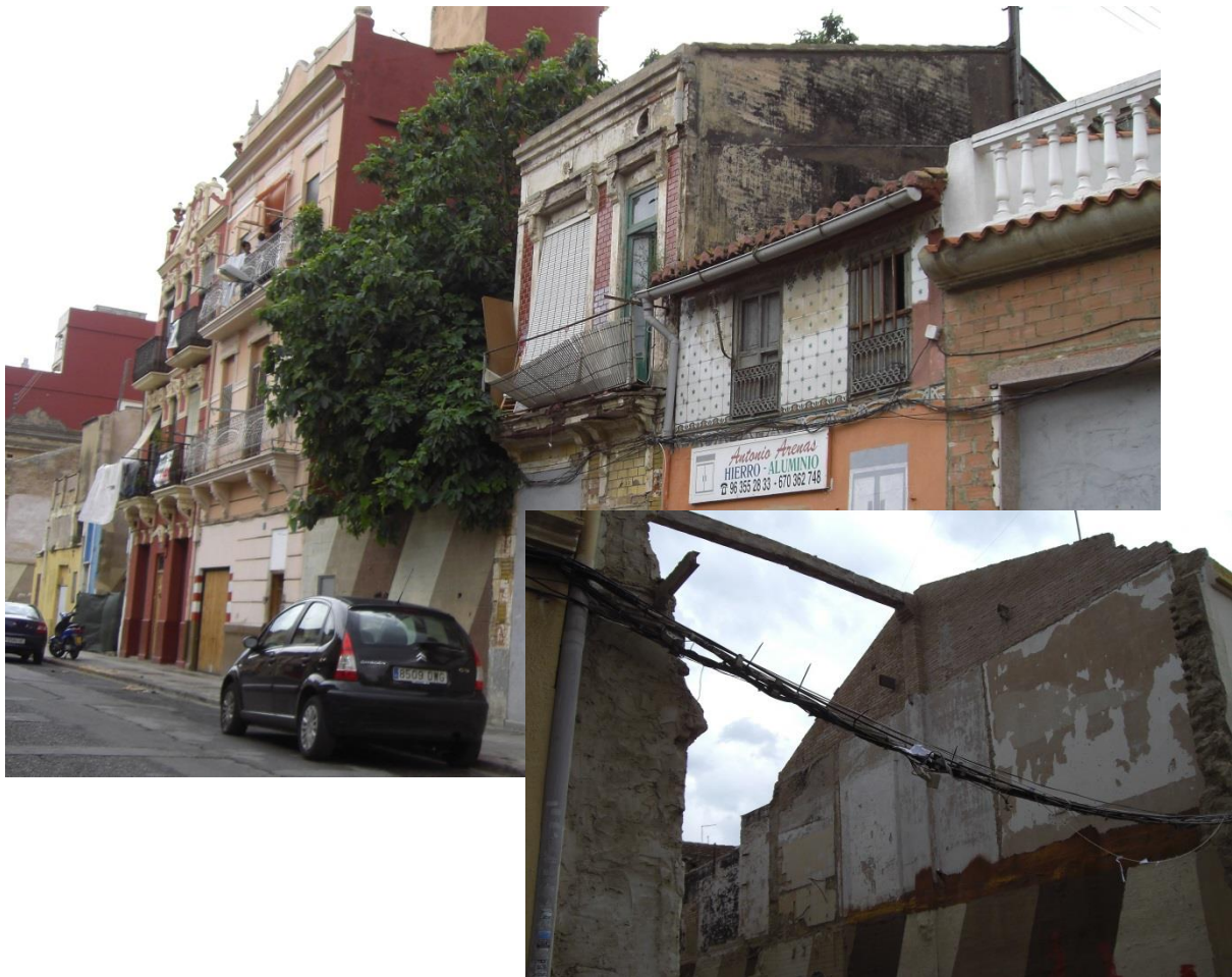
Imágenes nº 65-66.- Edificio en ruinas en la calle José Benlliure e instalaciones en mal estado en calle Progreso.
