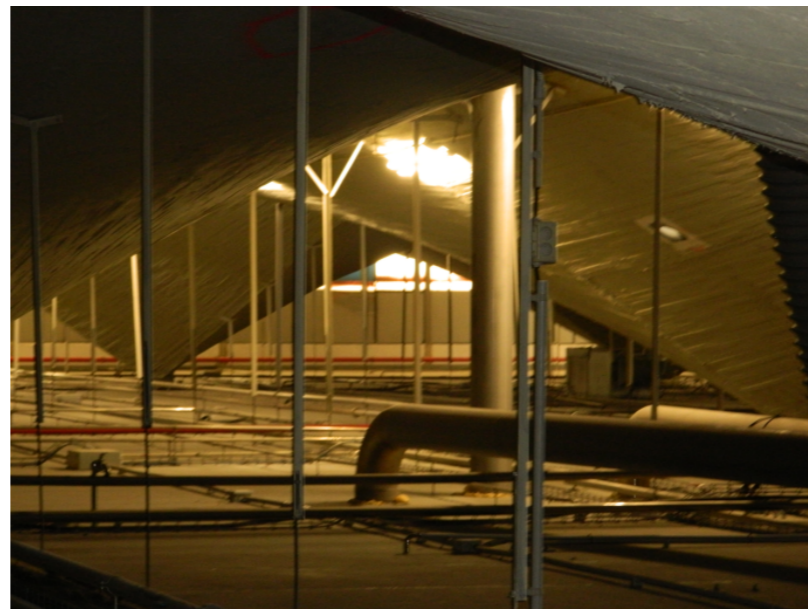
Foto 3.7 Paraguas Invertido en Interfruit (interior falso techo)
