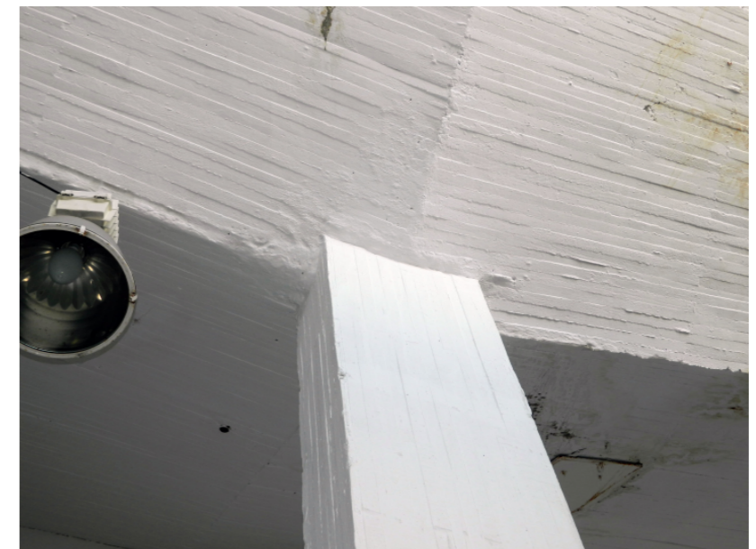
Foto 3.9 Paraguas Invertido en Interfruit 02 (interior de nave)
