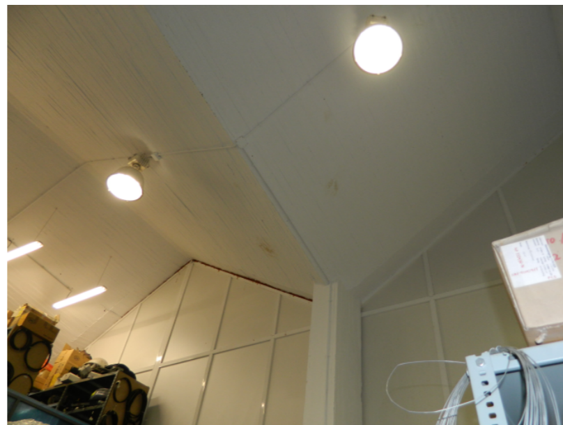
Foto 3.8 Paraguas Invertido en Interfruit 01 (interior de nave)
