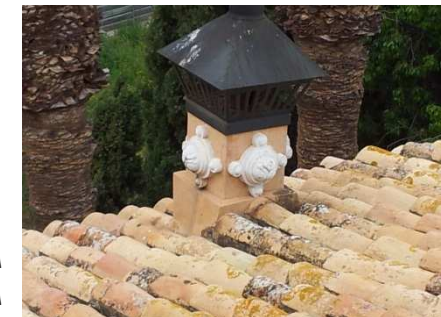
ENCUENTRO DE CUBIERTA CON CHIMENEA
