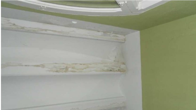
FOTO TOMADA EN EL MIRADOR UBICADO EN P.B Afección en Forjado
