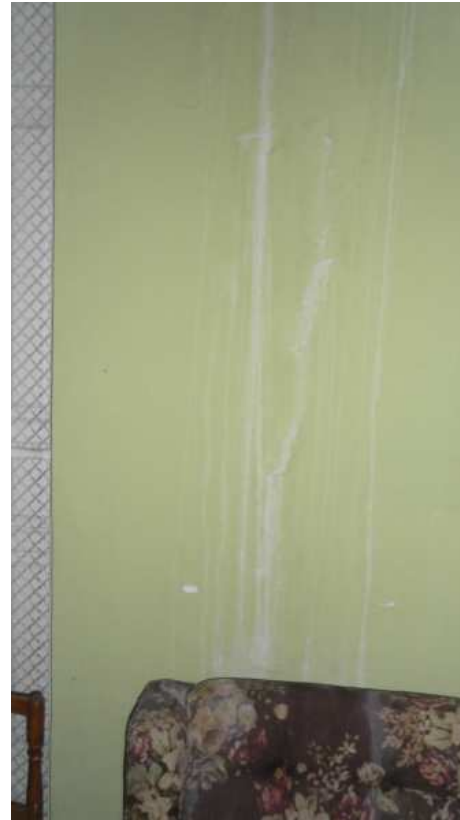
Afección en Pared
