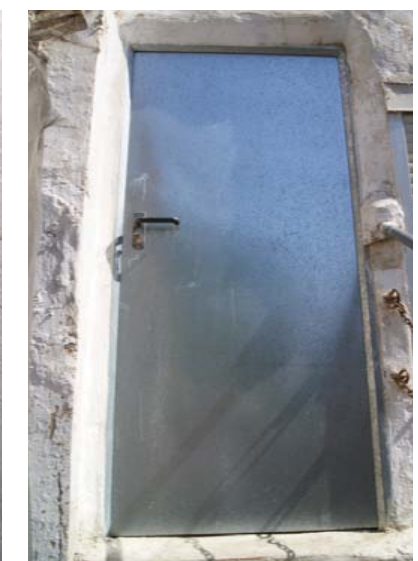
Fig3.78: Puerta acceso ELE
