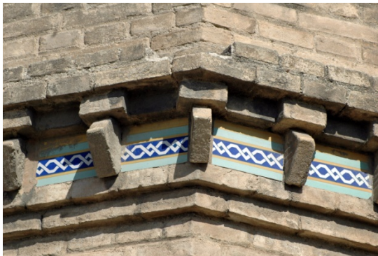
Figura 5.20: Ladrillo aplantillado utilizado para dentellado de cornisas en la chimenea de bodega, Albaida (Valencia)
