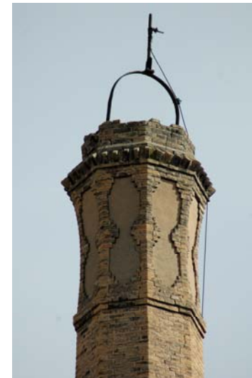
Figura 5.317: Barra recta de pararrayos en chimenea de ladrillera, Silla (Valencia)
