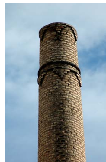
Figura 5.291: Detalle de dentellado modillón en imposta y motivo en cruz en final de fuste de chimenea de fábrica textil Terol Hnos, Alcoy (Alicante)
