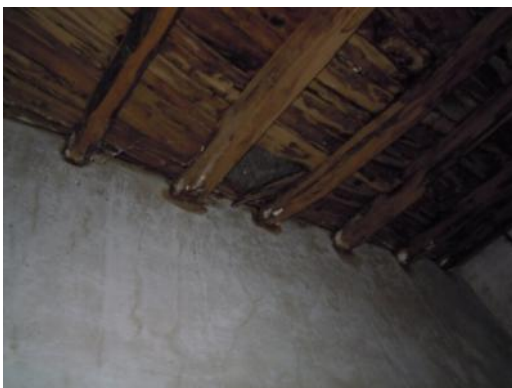
Pudrición de las cabezas de las vigas
