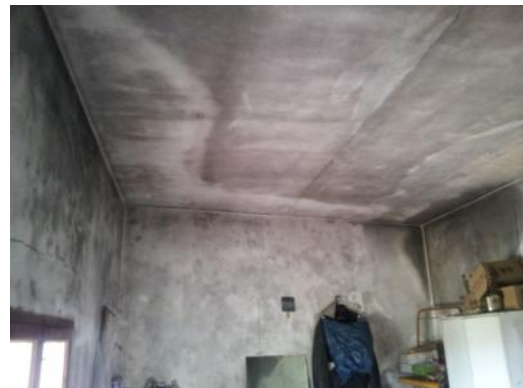
Humedad por filtración desde la cubierta en habitación exterior
