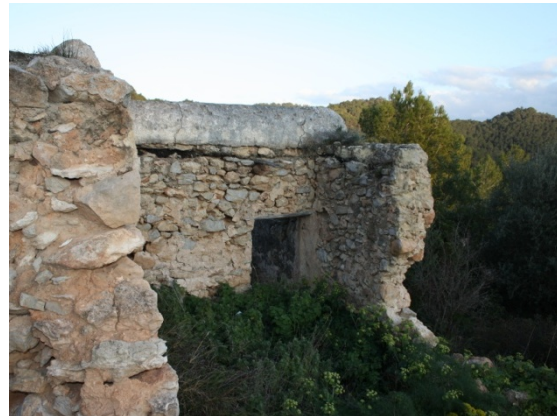
Fotografía uno de los muros derrumbados de la zona de corrales
