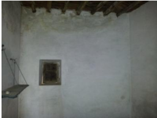
Humedad por filtración de la casa de jeure 2
