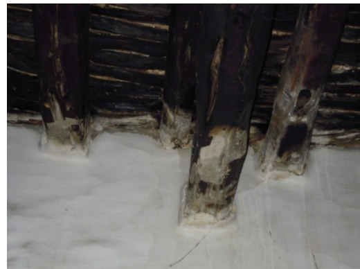
Pudrición de las cabezas de las vigas
