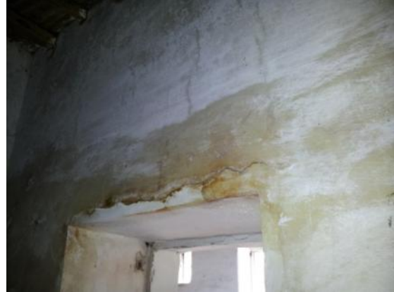
Fotografías del dintel afectado por humedad
