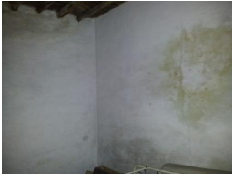
Mancha en muro afectado por residuo cerámico
