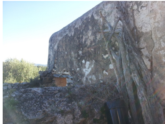
Suciedad en muros de zona de corrales
