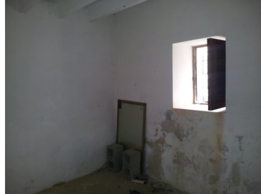
Humedad por capilaridad en habitación nueva 2
