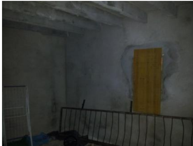
Vértice con manchas de humedad
