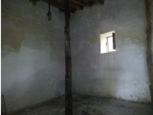
Humedad por capilaridad en casa de jeure 1
