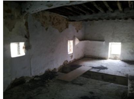
Humedad por filtración desde la cubierta y entre plantas
