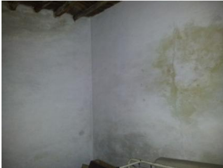
Fotografía del muro afectado por mancha verdosa
