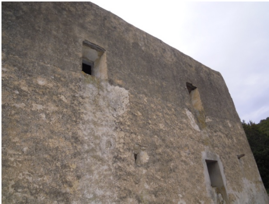
Suciedad en fachada este
