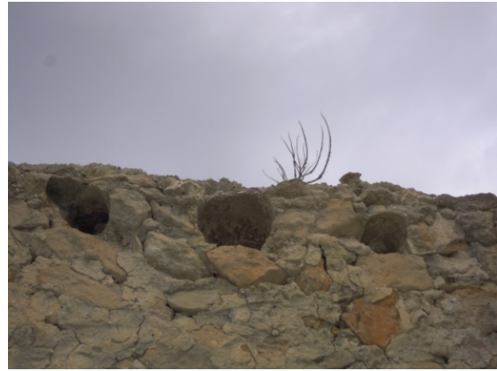
Fotografía de los huecos del muro, apoyo de las vigas ahora inexistentes
