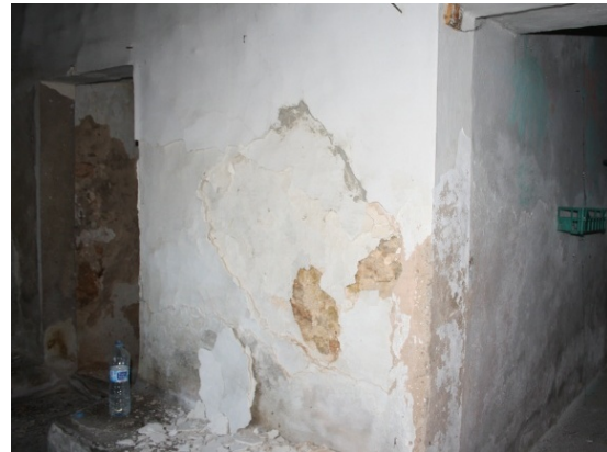
Desconchado y caída de revestimiento del muro
