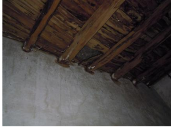
Cabezas de viga afectadas por humedad
