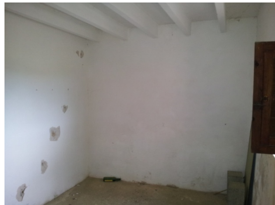
Da3os producidos por el anclaje de los escalones de madera
