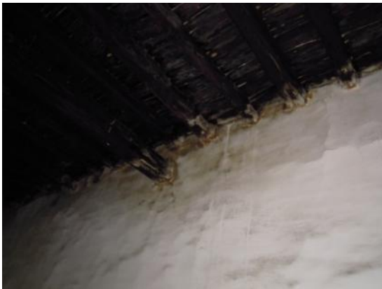
Abombamiento y caída de revestimiento del muro
