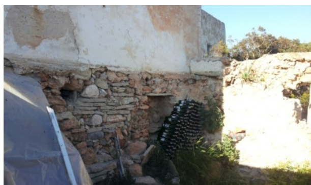
Fotografía del muro nuevo de bloque de hormig3n sobre muro antiguo de piedra (original de los corrales)
