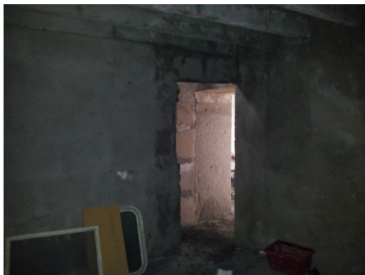
Humedad por filtración en junta del muro original con la parte nueva de la habitación nueva 1
