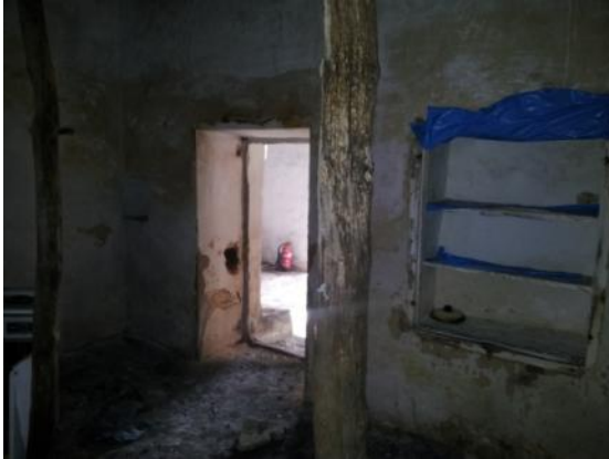
Fotografías de la pared donde se ubica el dintel afectado
