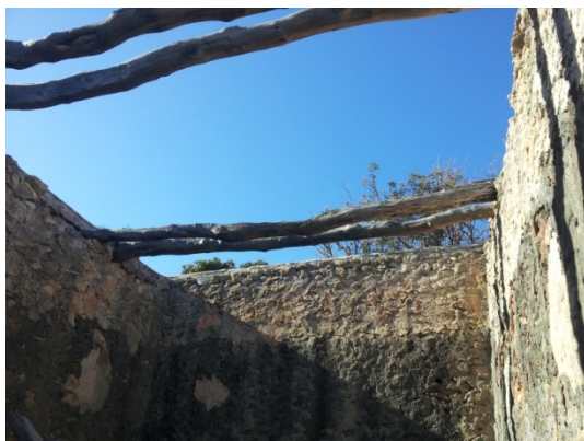
Restos de la cubierta
