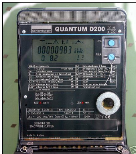
Figura 2.7 Contador de energía eléctrica Quantum D200 empleado para la medición del consumo eléctrico de los compresores instalados en los diferentes prototipos experimentales.
