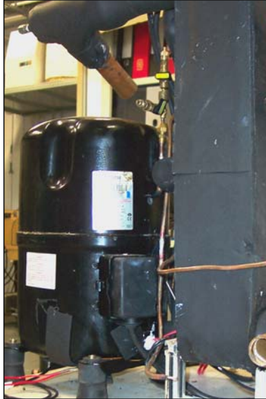
Figura 2.13 Compresor alternativo TECUMSEH instalado en los prototipos 2 y 3.
