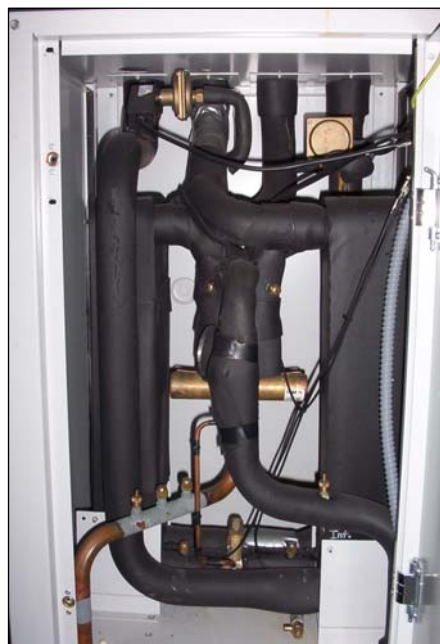
Figura 2.15 Detalle del circuito frigorífico del prototipo 6, y de la longitud de la línea de líquido que une ambos intercambiadores de calor.
