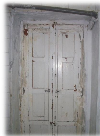
Fig.87.-Puerta de ventilación natural en sala de trabajo.
