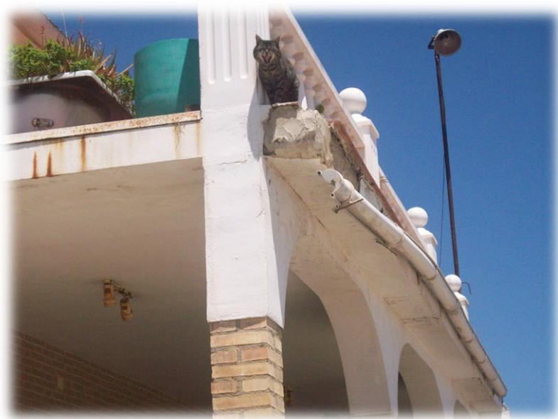
Fig.122.-Canalón en mal estado
