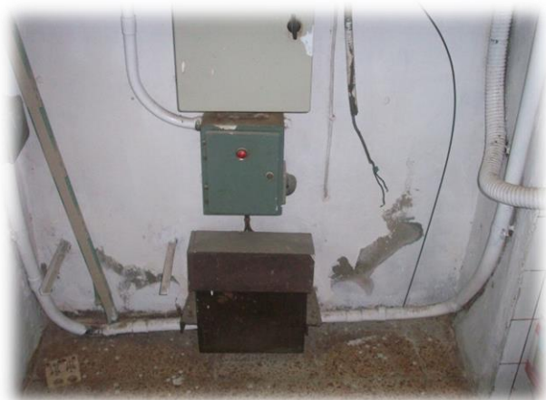
Fig.124. -Instalaciones eléctricas en mal estado
