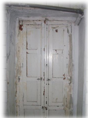
Fig.120.-Carpintería. Mal estado
