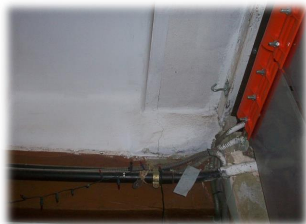
Fig.125. -Instalaciones en mal estado
