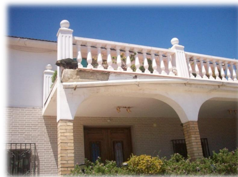
Fig.123.-Canalón en mal estado
