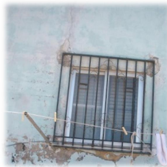
Fig.121.-Fisuras y manchas.
