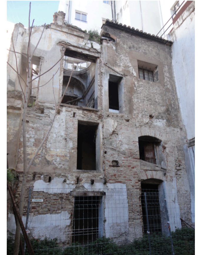
Zona de la capilla extremadamente deteriorada
