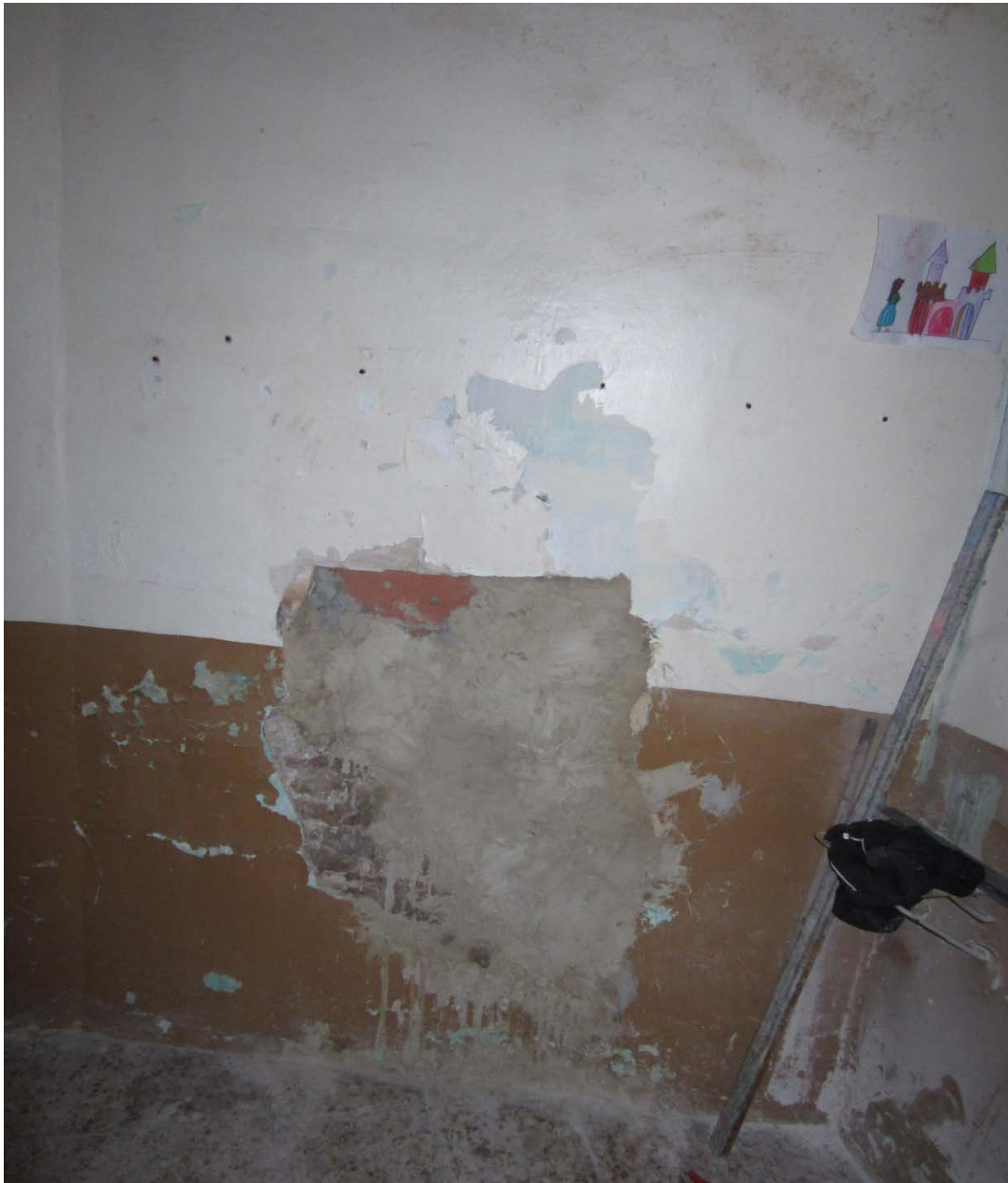
Se puede observar el butrón en la pared
