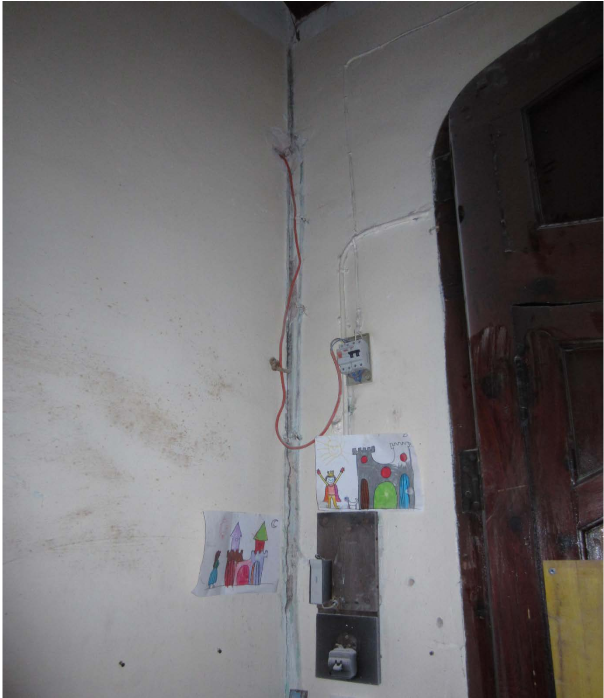
La grieta llega desde el forjado superior hasta el suelo
