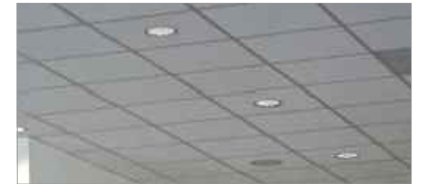
2_falso techo bandejas metálicas
