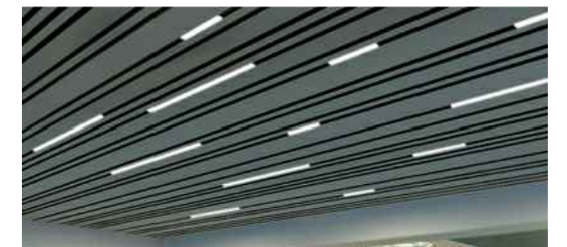
3_LEDs integrados en falso techo (sistema lightline)
