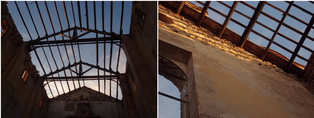
Restos de la cubierta de madera
