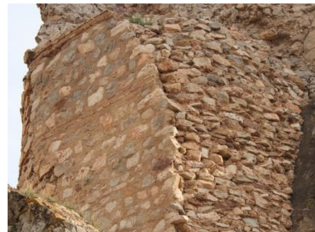
Detalle de muro de cerramiento de torre redonda con mampuesto careado en cara exterior, hilera regularización de ladrillo.
