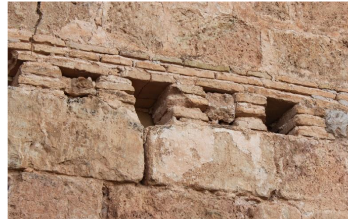
14. Foto detalle de las vigas de la antigua dirección del forjado, cegados posteriormente
