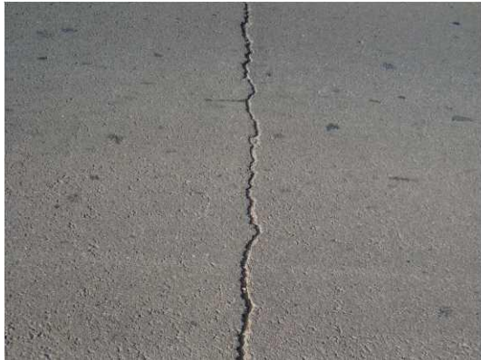
Grieta del asfalto Av los naranjos
