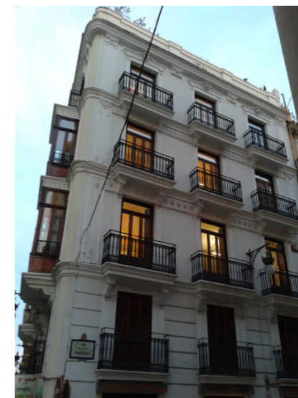
Imagen de fachada lateral donde se observan las moluras a la altura del canto del forjado.
