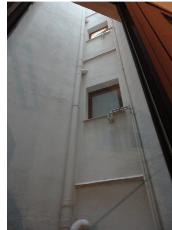
Imagen de bajante de aguas residuales procedente de los cuartos de baño
