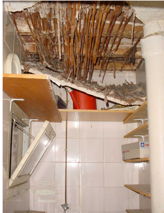
Derribo del forjado, desprendimiento del cañizo.
