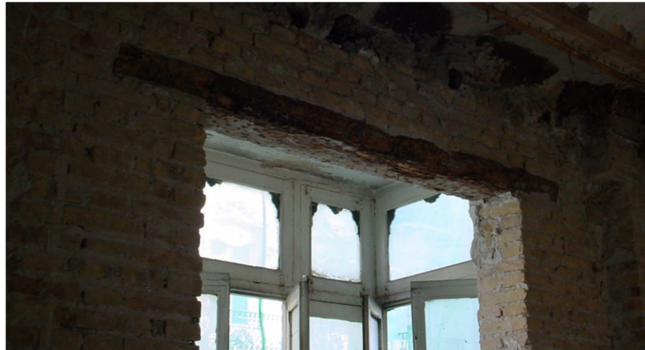
Imagen del hueco del mirador con dintel de madera y fachada de fábrica de ladrillo macizo de l'asta.
