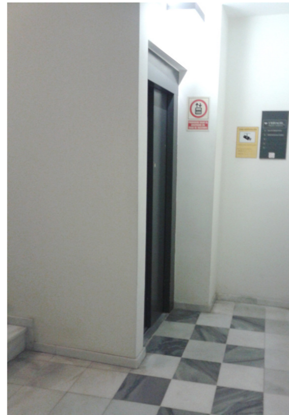
Ascensor común del edificio
