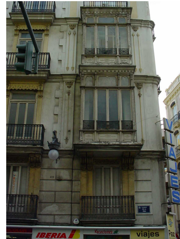
Carpintería original antes de la intervención
