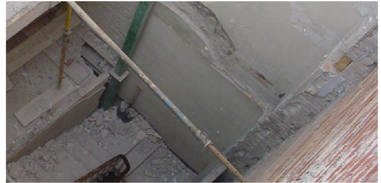
Imagen durante la demolición donde se puede observar el muro medianero de fábrica de ladrillo macizo.
