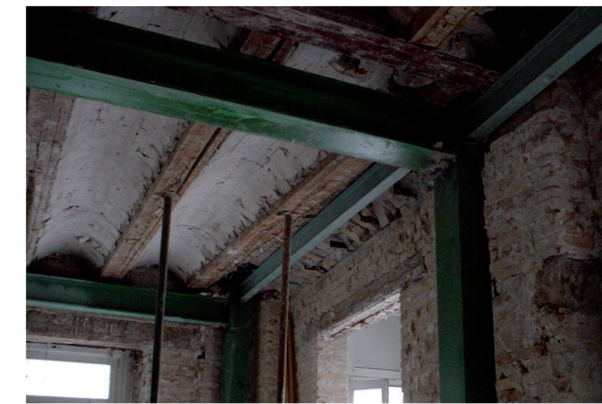
Colocación de la nueva estructura metálica, utilizada como arriostramiento de la fachada
