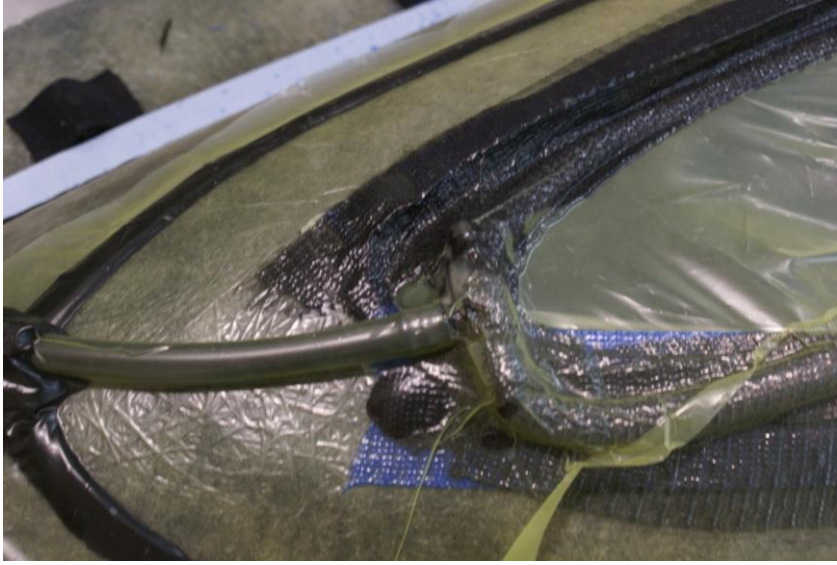
Figura 6-22 Detalle de uno de los tubos que efectúa vacío.
