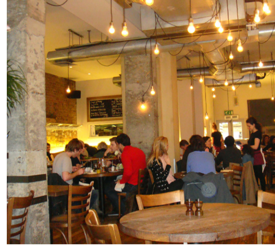
Instalaciones vistes en el bar cafe planta baja
