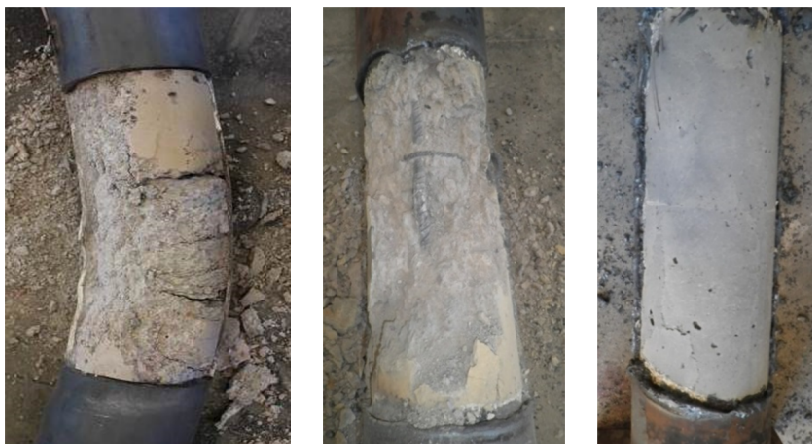
Figura 4.35. Fisuración del núcleo de hormigón
