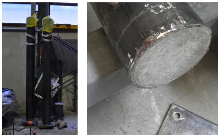
Figura 4.8. Tubos hormigonados (izq.) y detalle del pulido del recredido de hormigón antes de soldar la placa superior (der.)
