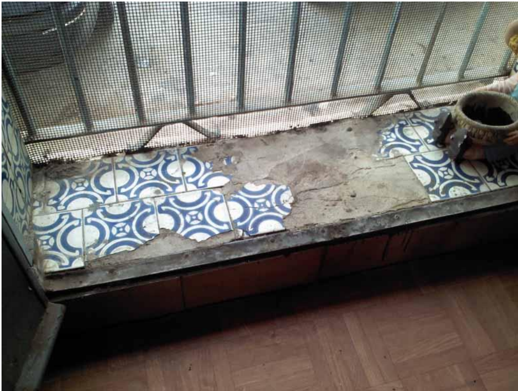
Estado del ventanal que mira al interior, al patio vecinal.
