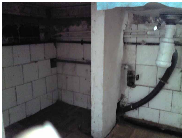
Estado de la fontanería y desagües en la cocina.
