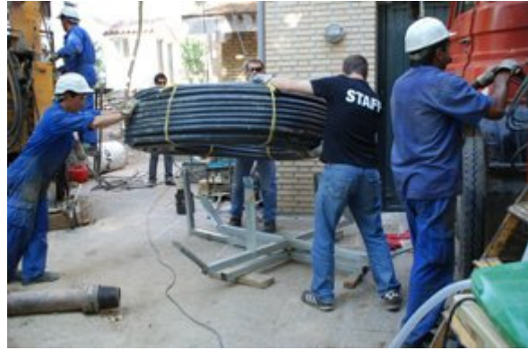
Figura 34. Descarga de colector
