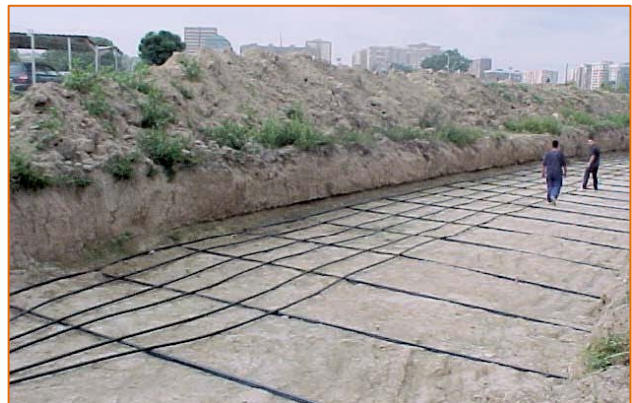
Figura 28. Conducciones en la periferia de edificio
