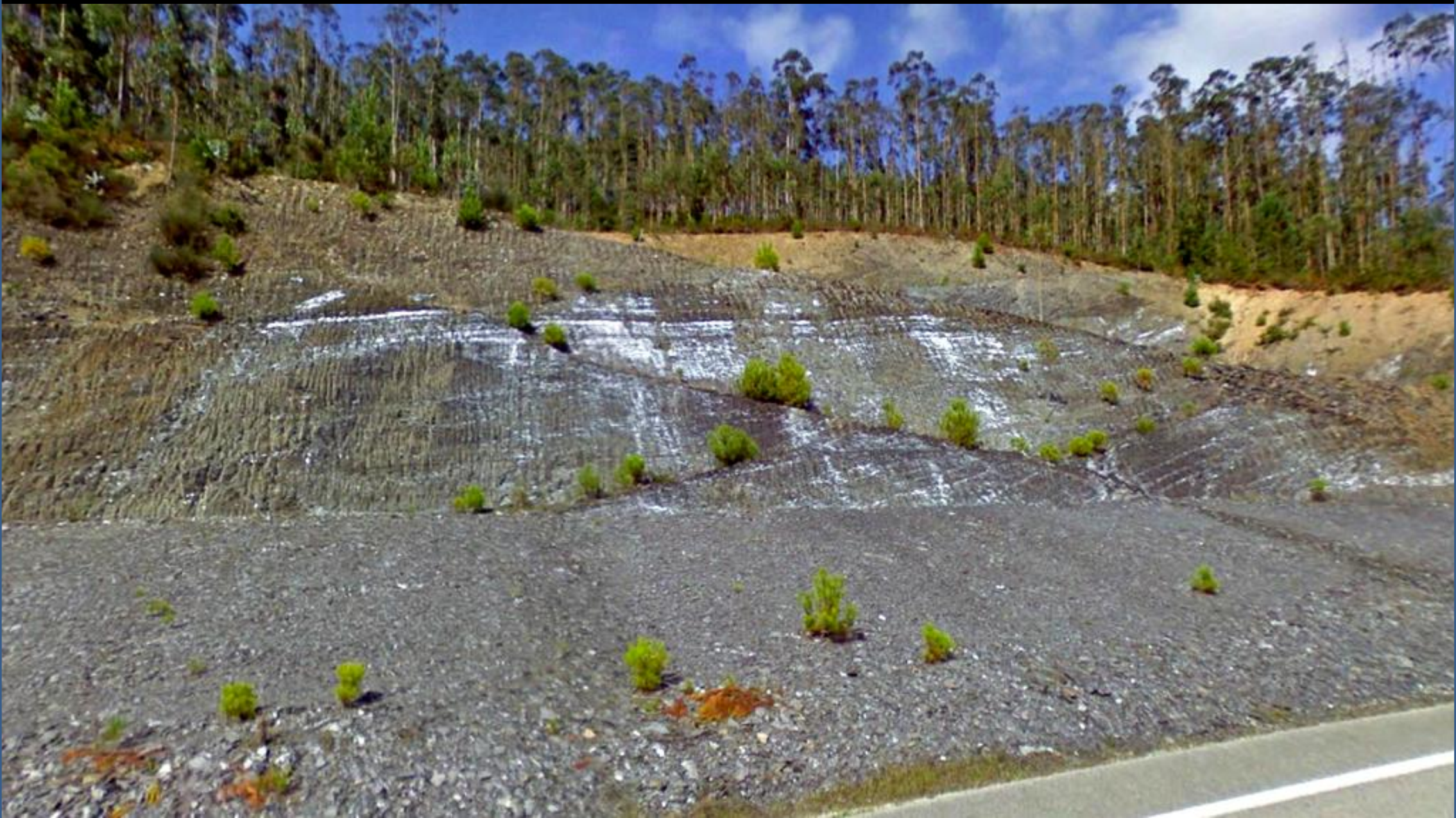
Inestabilidad del talud en las pizarras y cuarcitas de la Serie de Los Cabos, Cambro-Ordovícico, al N de Soenlle, Lugo. NW Hoja de Vegadeo.
