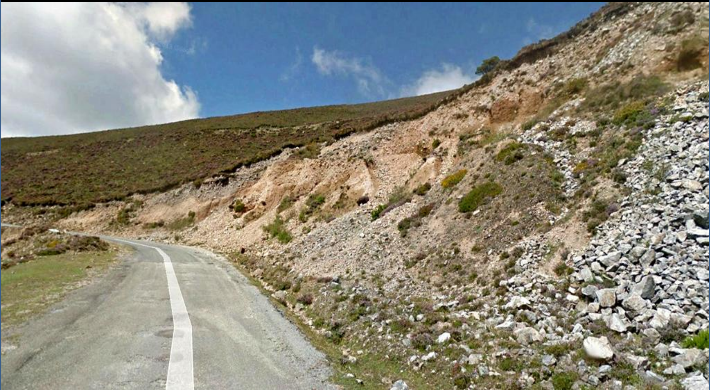
Talud inestable en depósitos de ladera en zona de cuarcitas del Cámbrico. E de Come de Cabaleiro, W de Folgueiras, Lugo. NE Hoja de Puente de García Rodríguez.
