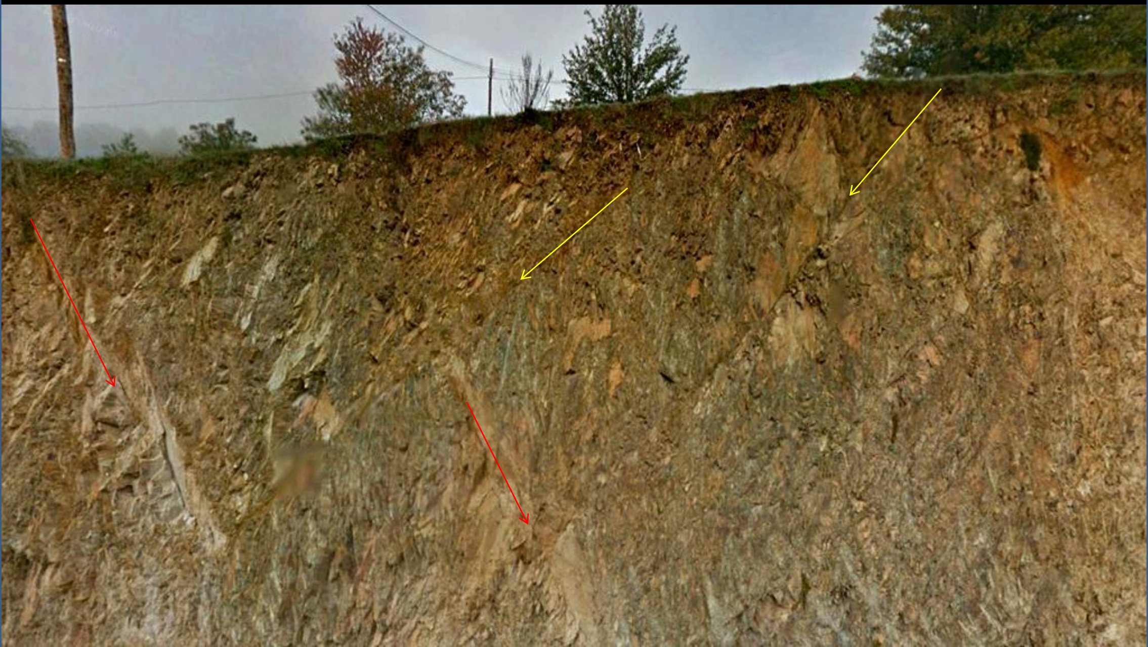
Fallas paralelas y ortogonales en los Paleozoicos al NE de As Pontes de Gatín. SW Hoja de Becerreá.
