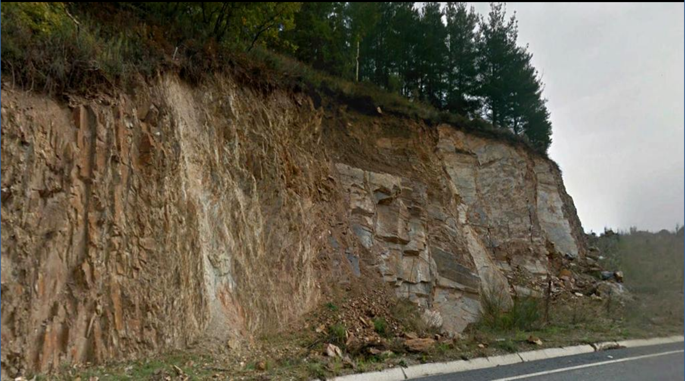
Cuarcitas claras del Ordovícico. Inestabilidad de talud. NE de As Pontes de Gatín. SW Hoja de Becerreá.
