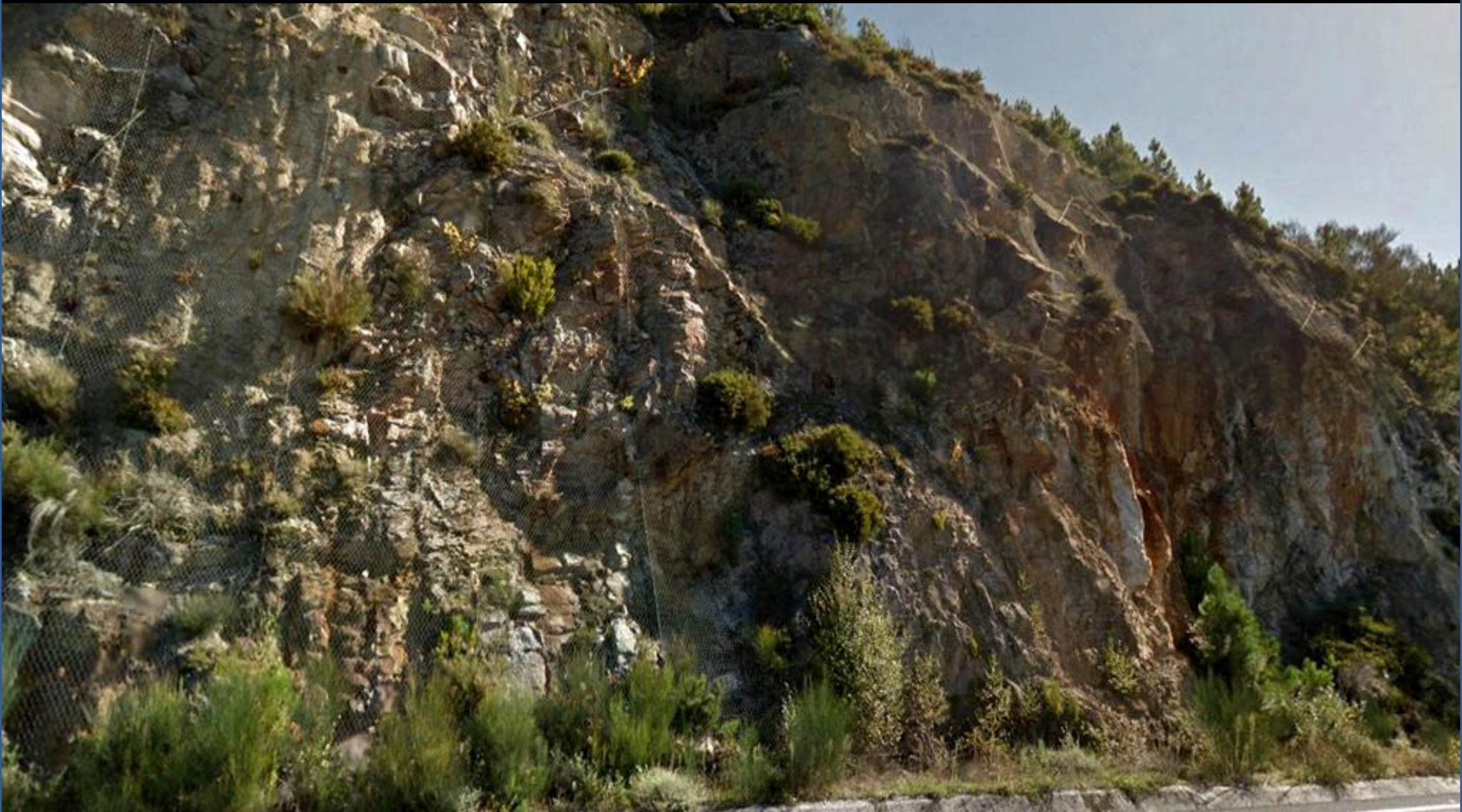
Talud con mallazo en zona de cuarcitas y esquistos del Precámbrico-Ordovícico. SE de Chouzan, Lugo. S Centro Hoja de Chantada.
