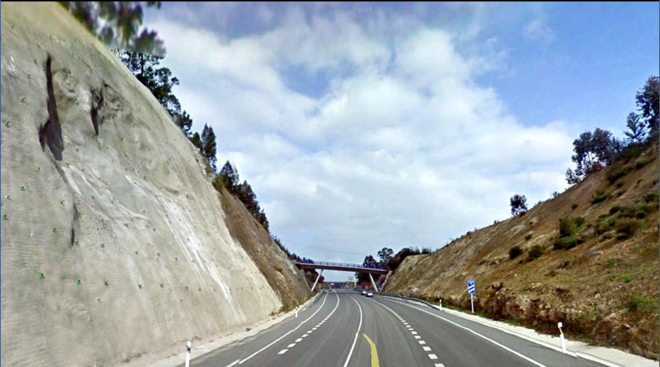
Bulonado y gunitado en el talud de granito, al NE de Caldas de Reyes, Pontevedra. NE Hoja de Villagarcía de Arosa.
