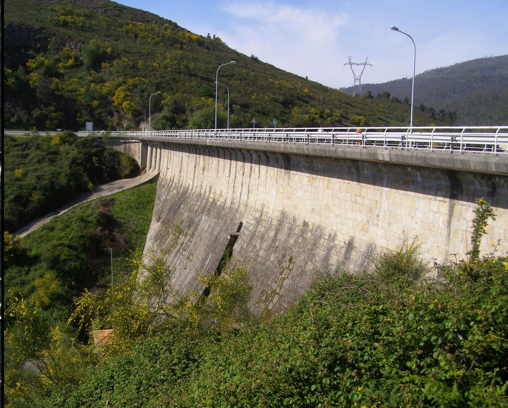
Embalse del Portillón do Castro. N de Verducido, Pontevedra. Cerrada. NE Hoja de Pontevedra. (por Irimo-Google)
