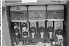
Imagen 9. Inst. prov. de suministro: cuadro eléctrico de obra
